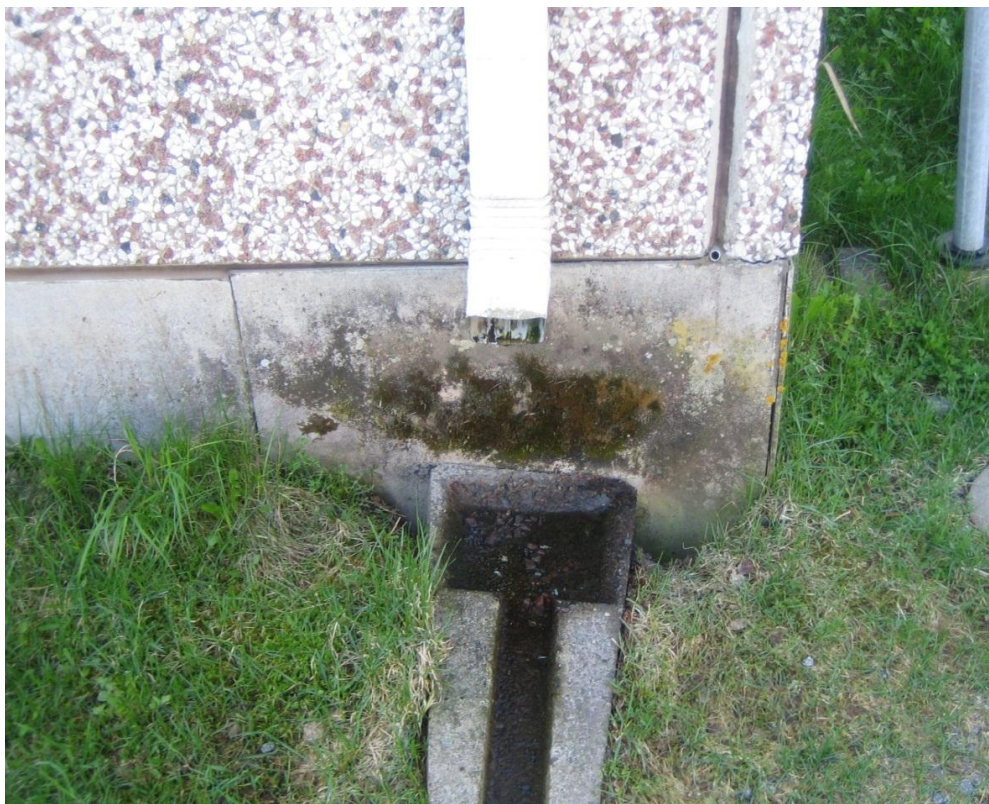
Kuva 2. Sadevesien "ulosheitto" kaataa nyt perustuksiin päin.
