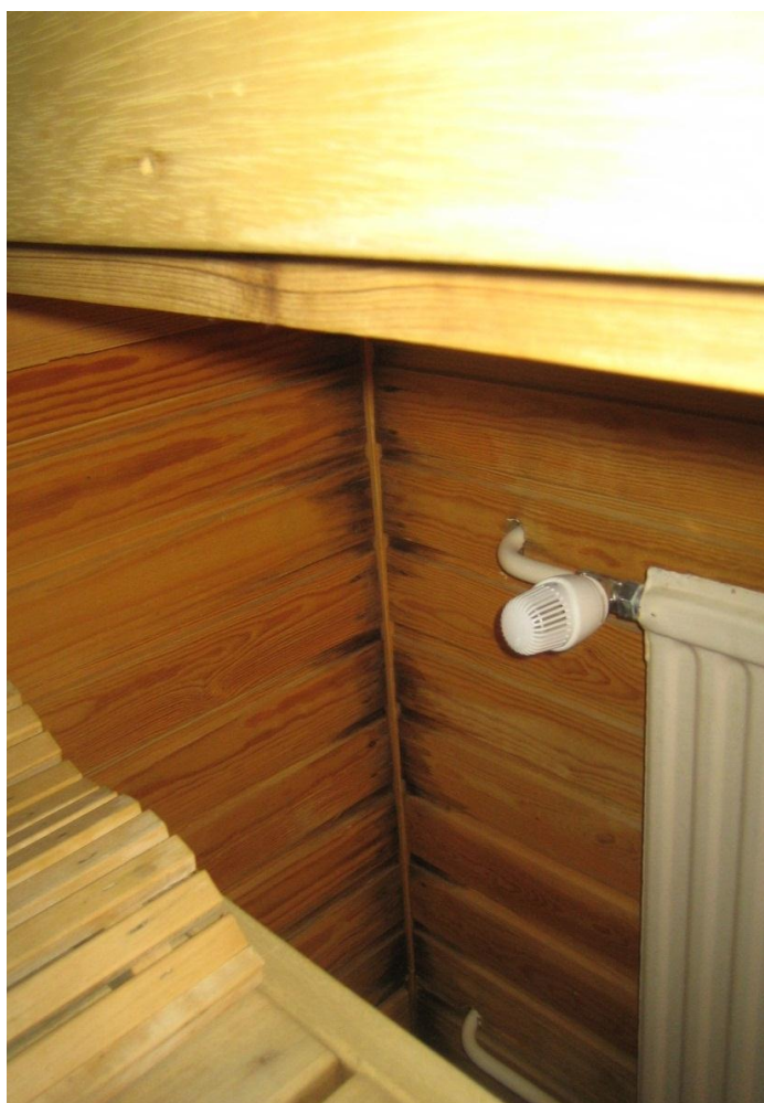
Kuva 4. Huoneistojen saunojen panelit tummuvat nurkista.
