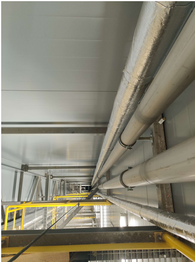
KUVA 7. Viemäri- ja käyttövesirungot putkikuilussa
