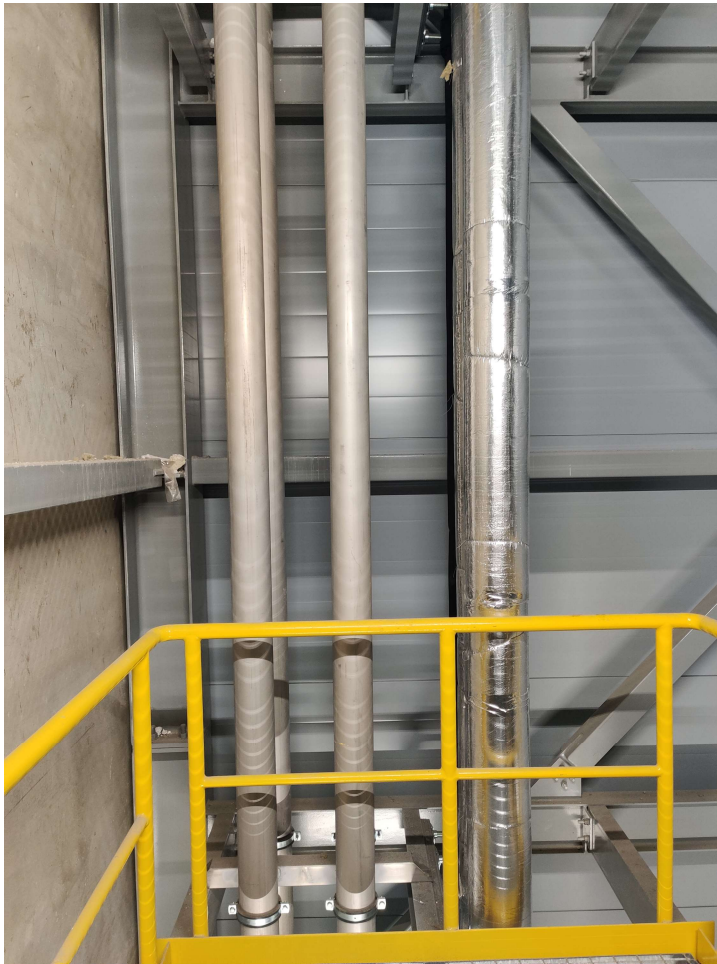
KUVA 6. Lauhde- ja jäähdytyslinjat putkikuilussa
