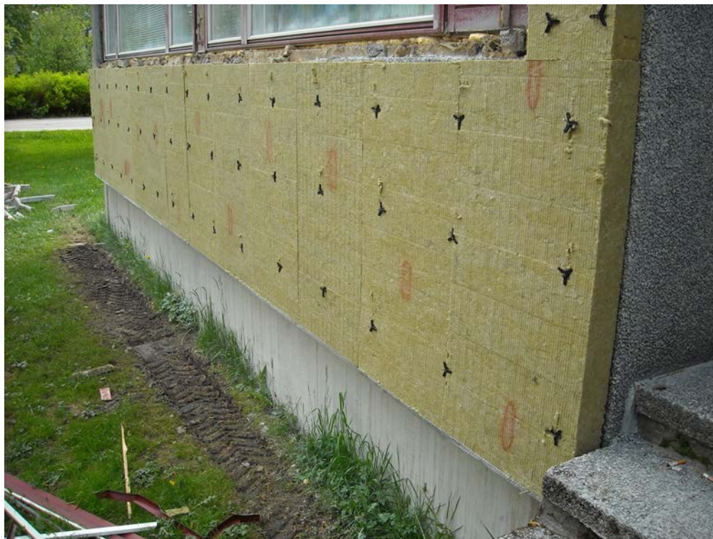
Kuva 22. Runosmäen taloja on saneerattu paljon. Kuvassa on nähtävissä, kuinka lisäeristäminen nostaa julkisivun pintaa.
