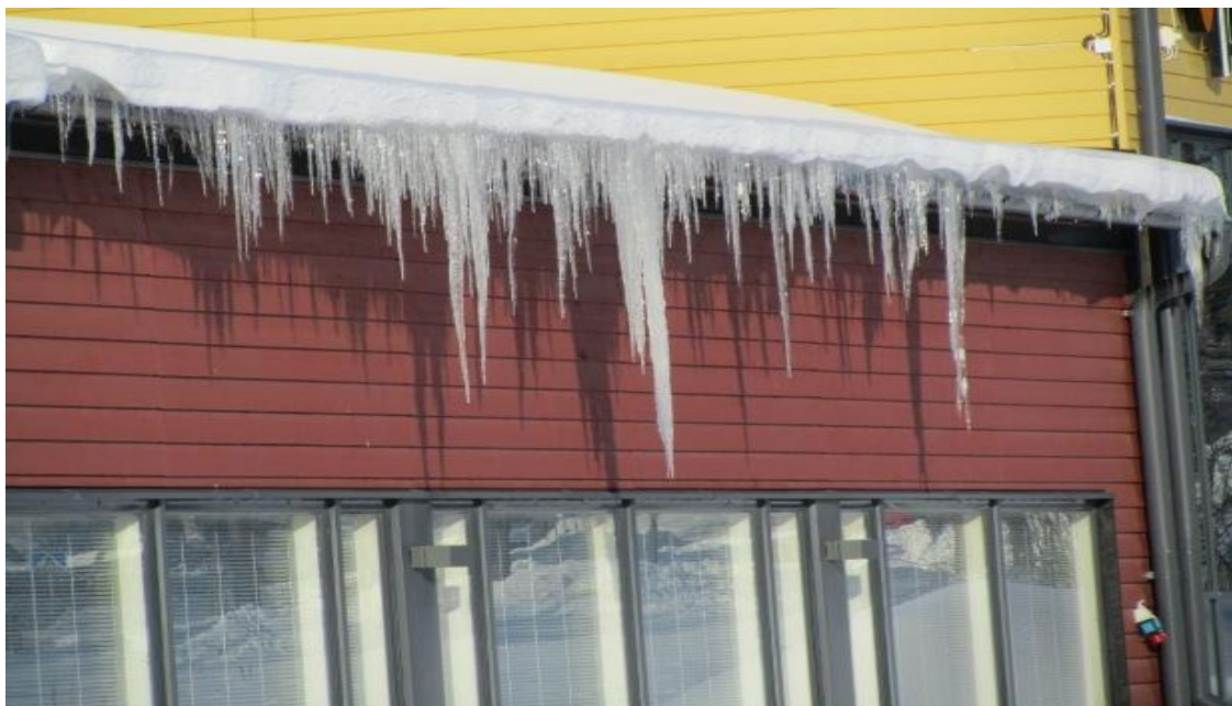
Kuva 5. Lämpövuoto havaittu uudessa rakennuksessa takuuajana.
