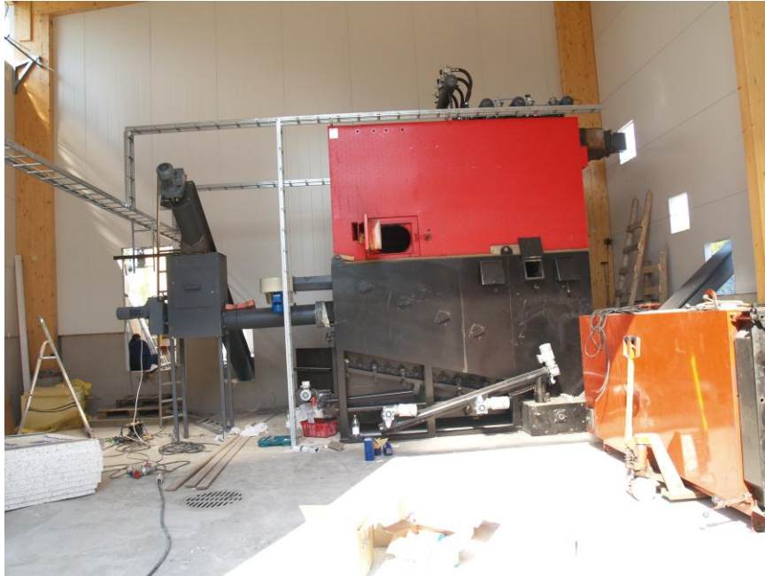
KUVIO 3. Biolämpökattila on nimellisteholtaan 1 MW, varalämmönlähteenä toimii 1 MW:n öljykattila
