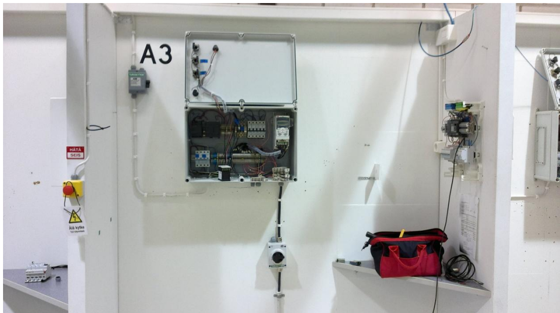
Kuva 4. Sähköalan työpistepiste Malmingin kampuksella
