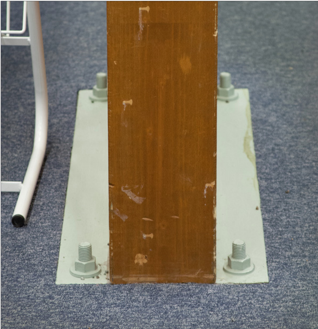
Kuva 4.1. Käytettävyyden ja ulkonäön kannalta huono liitosratkaisu
