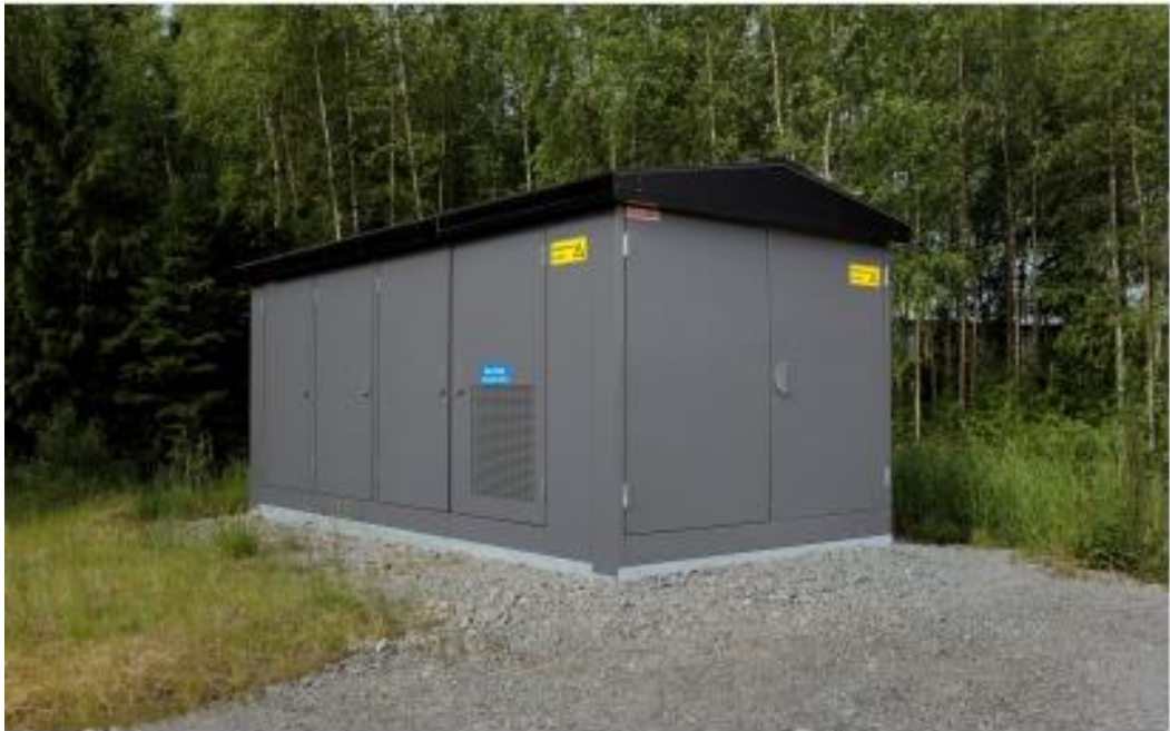
Kuva 5. Alfen Elkamo Oy:n valmistama ELMO-puistomuuntamo. /10/
