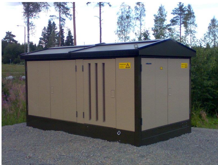
Kuva 3. Finnkumu Oy:n valmistama ilmaeristeinen jakelumuuntamo. /6/
