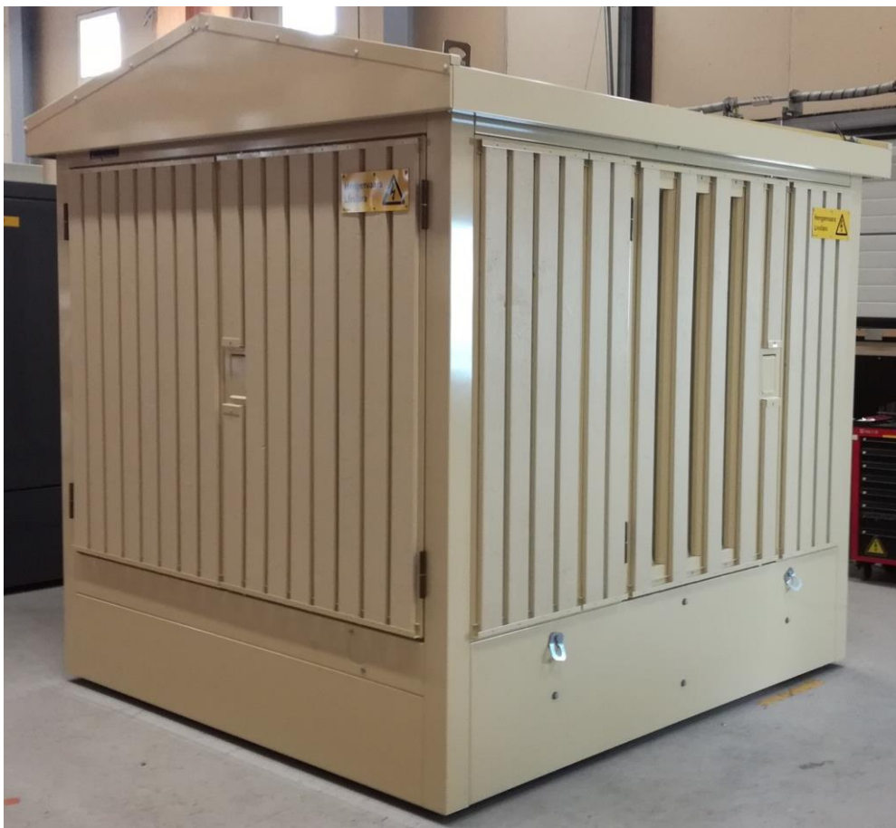
Kuva 6. Lautaverhoiltu erikoisvärinen Finnkumu -MTS -muuntamo. /3/
