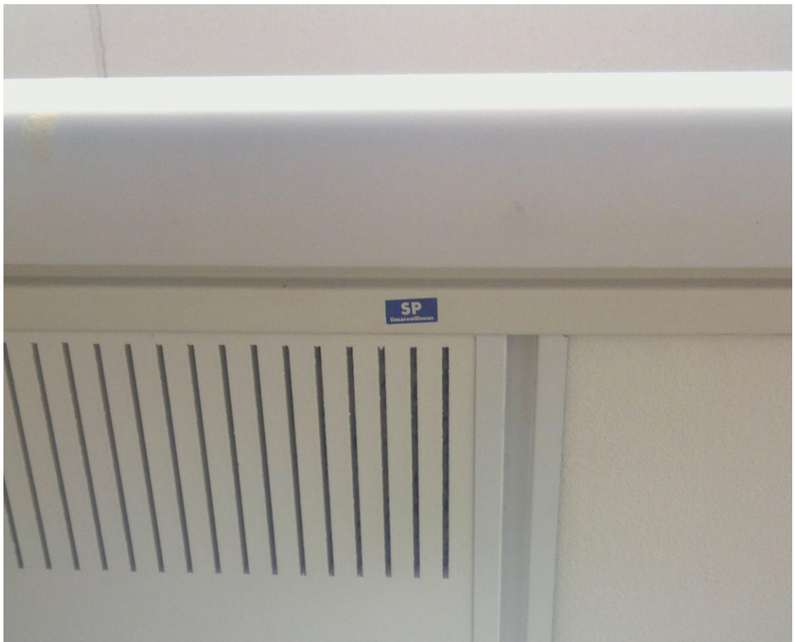
Kuva 1. Tarramerkinä on siisti tapa merkitä piiloon asennettu säätölaite alaslaskettuun kattoon. Tarramerkinä nopeuttaa säätölaitteiden paikantamista.
