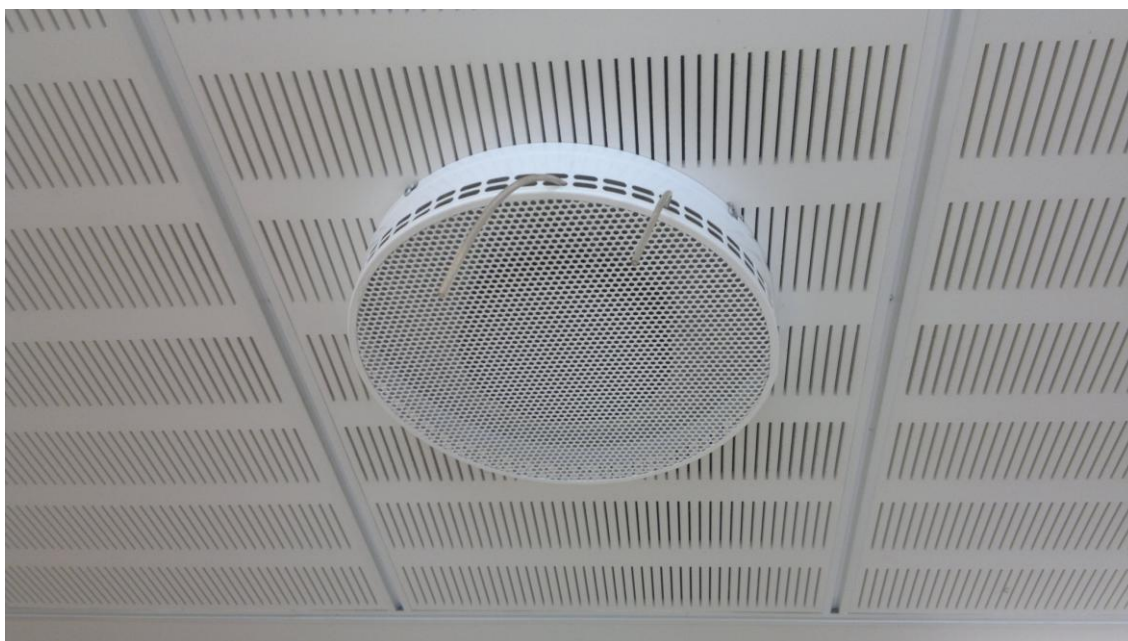
Kuva 4. Roikkumaan jätetyt tuloilmalaitteen mittayhteet näyttävät epäsiisteiltä.
