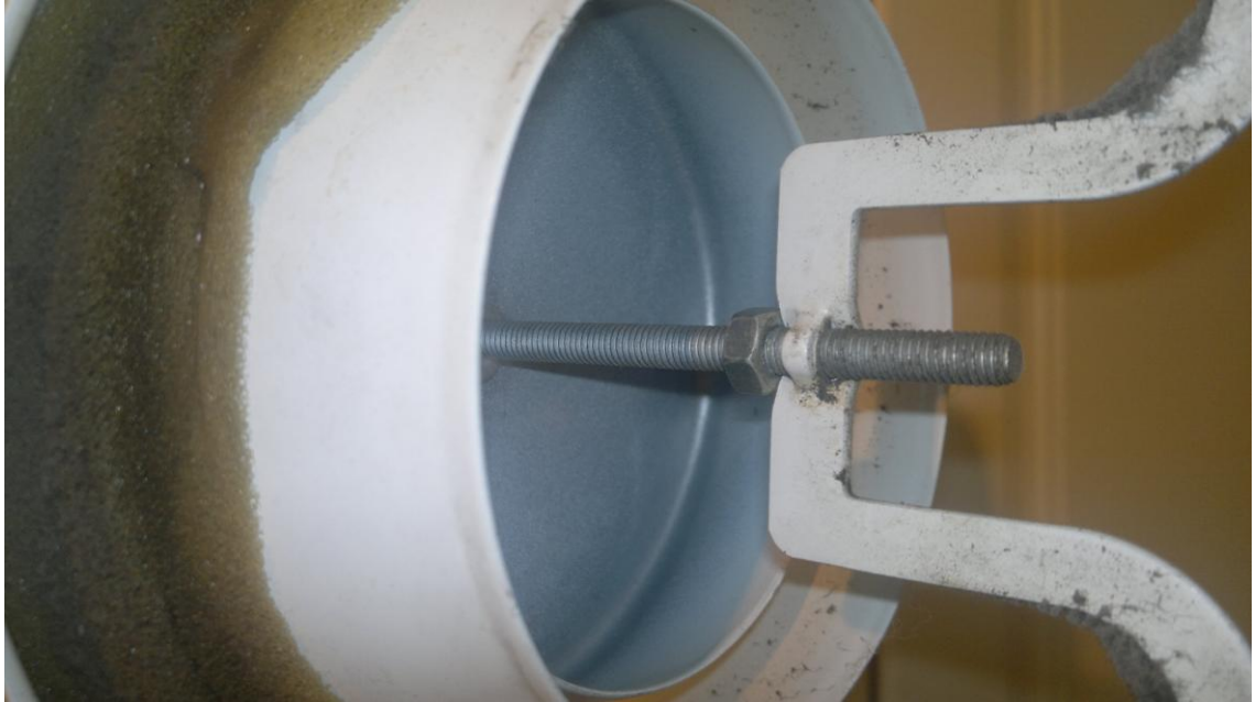
Kuva 2. KSO-125-venttiili irrotettuna ja lukittuna säätöasentoonsa. Tämä keittiön venttiili olisi pölynpoiston ja tiivisteenvaihdon tarpeessa.
