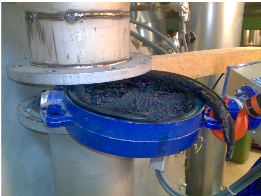
Kuva 6, Puhdistettavan päästön aiheuttamaa tukkeumaa kattilan läppäventtiilissä (Järvelä 2009)
