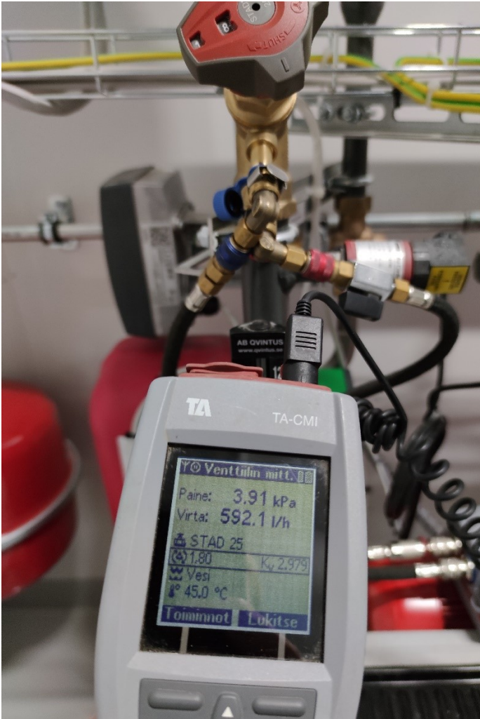
Kuva 17. Ilmanvaihdon lämmitysverkoston päävesivirran mittaus alajakokeskuksen linjasäätöventtiililtä.
