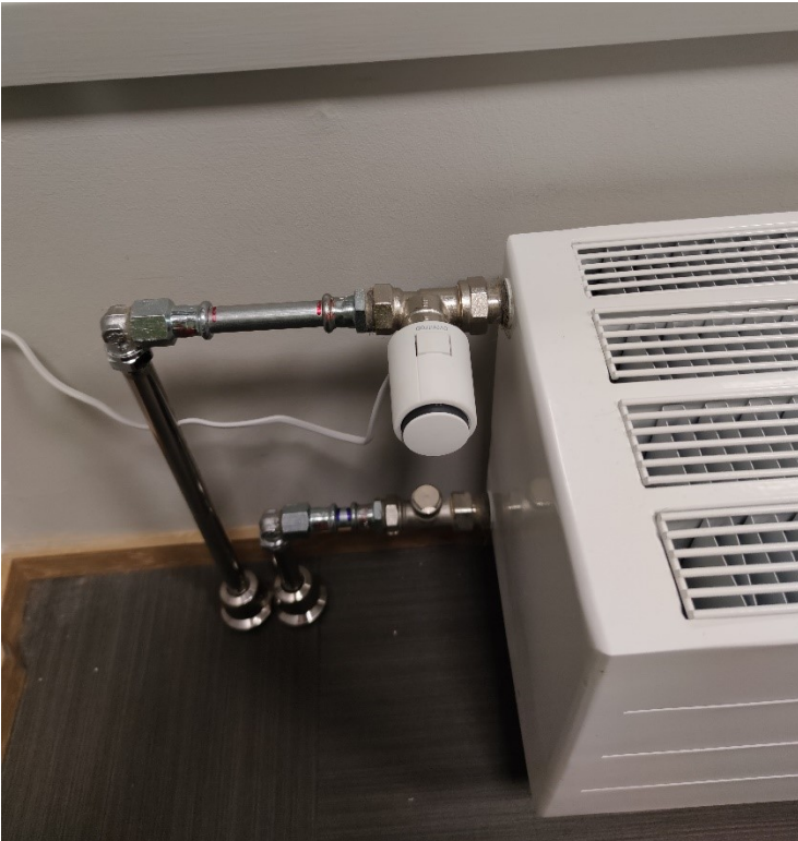
Kuva 7. Sähköinen toimilaitte asennettuna patteriventtiiliin.
