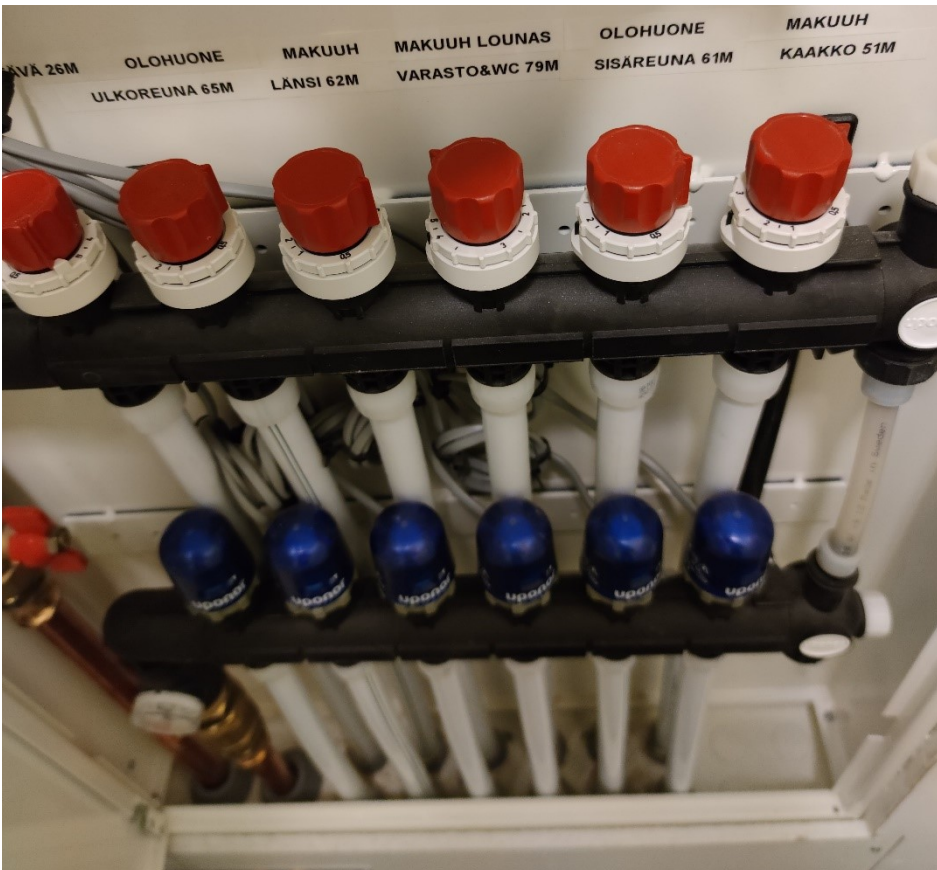
Kuva 4. Lattialämmitysjakotukki venttiileineen ja toimilaitteineen.
