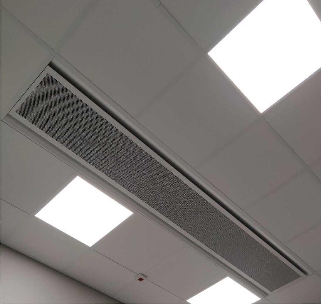
Kuva 13. Jäähdytyspalkki neuvottelutilan katossa.
