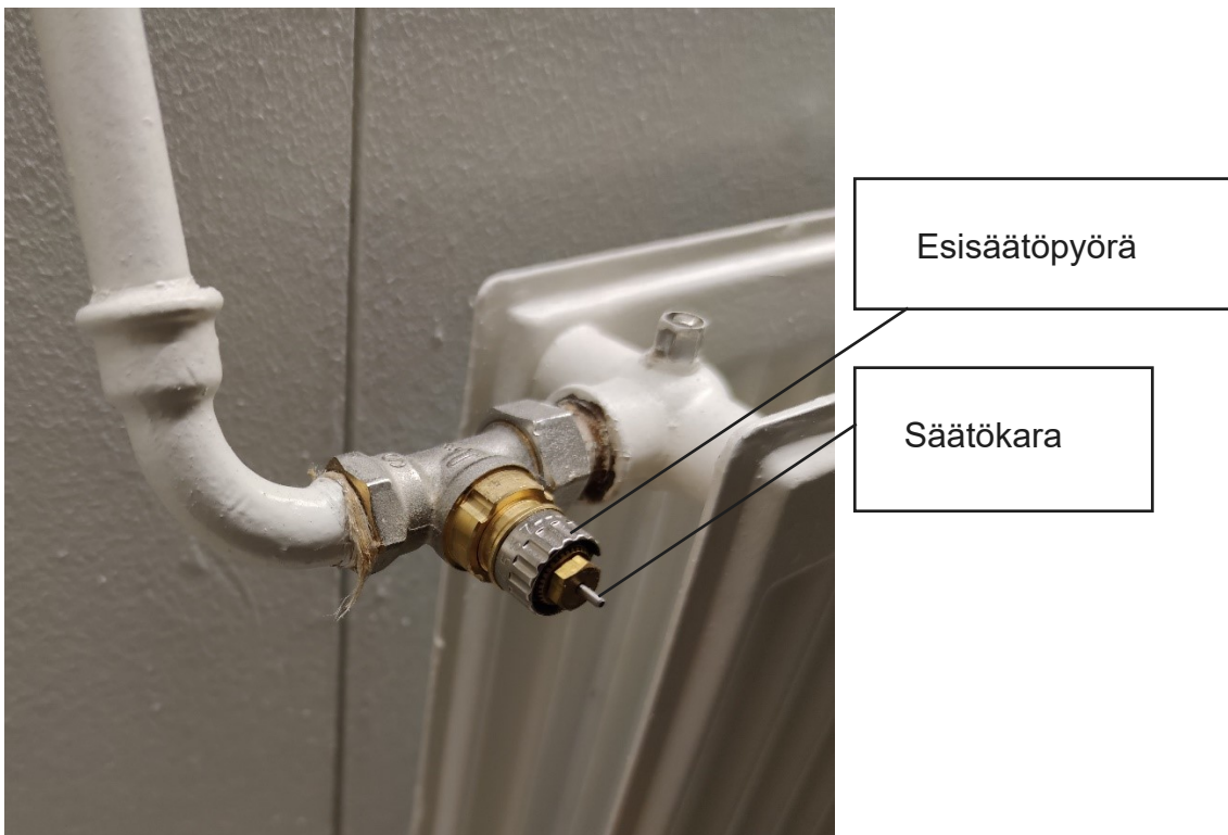
Kuva 2. Danfoss RA-N -merkkinen patteriventtiili patterin menoputkessa.
