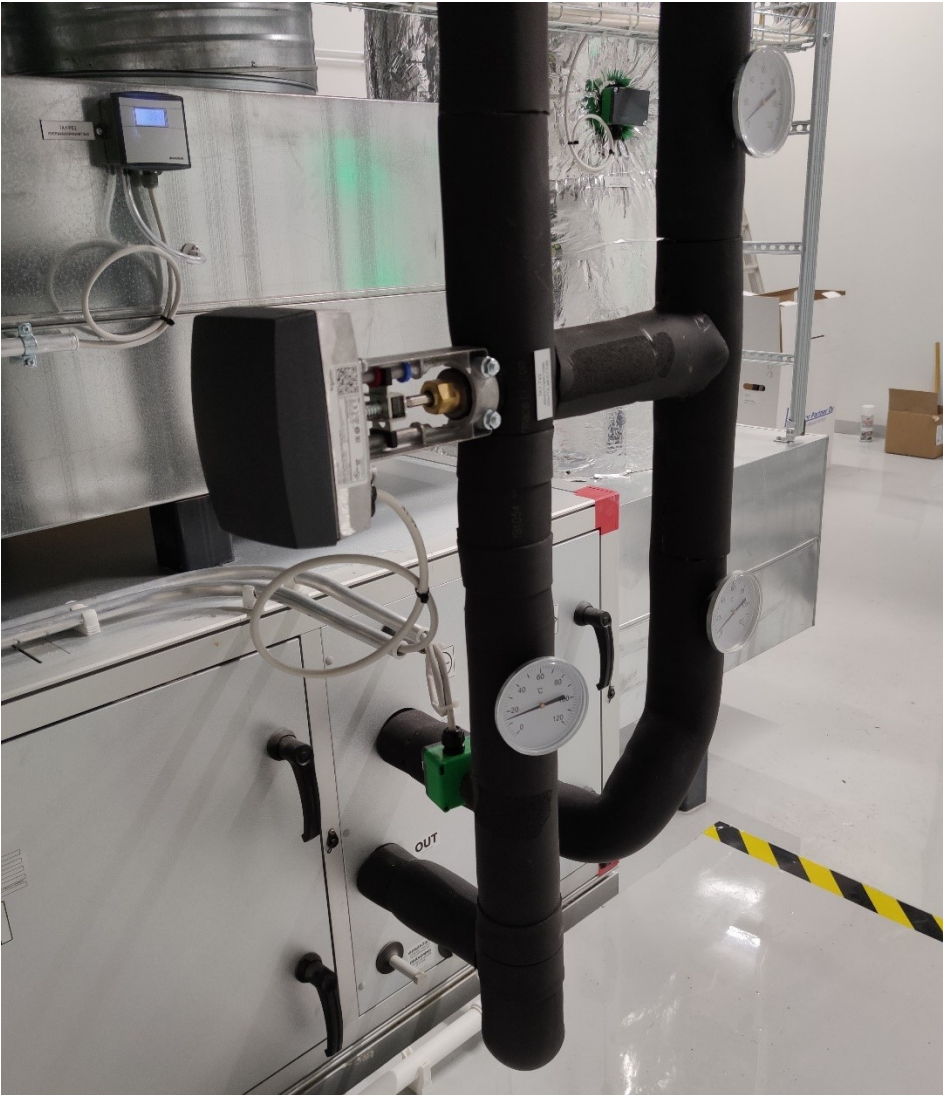
Kuva 12. IV-koneen jäähdytyspatterin sekoitusventtiili ja putkikytkennät.
