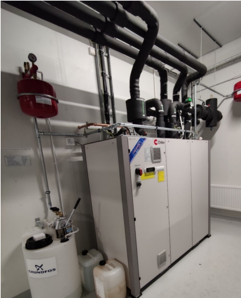
Kuva 14. Vedenjäähdytyskoneen kylmävesiasema komponentteineen.
