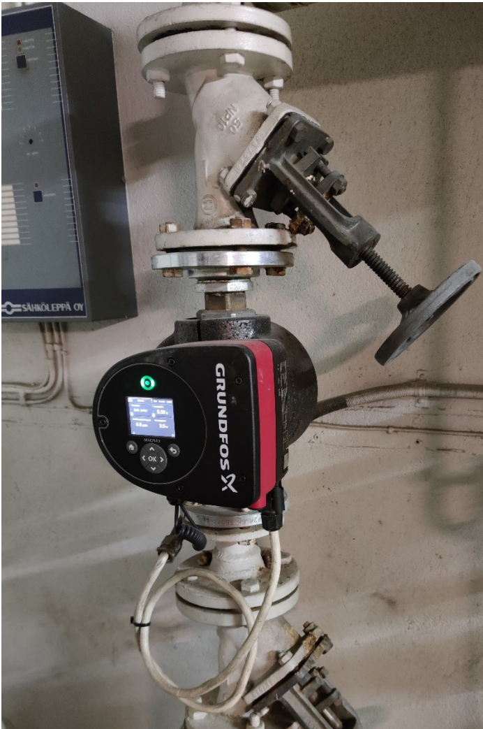
Kuva 8. Grundfos Magna3 kiertovesipumppu asennettuna lämpöjohtoputkeen.
