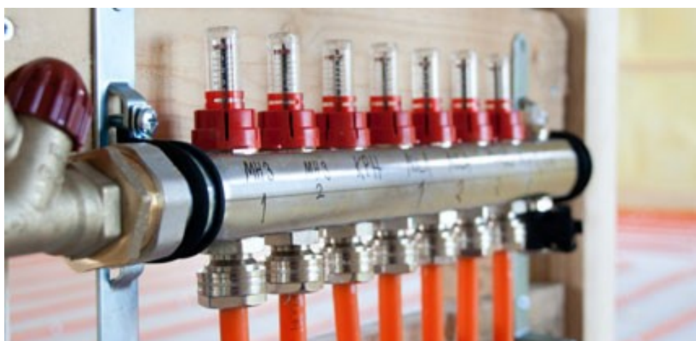
Kuvio 8. Lattialämmitysjakotukki virtausmittareilla (Muovitech, [viitattu 10.3.2021]).
