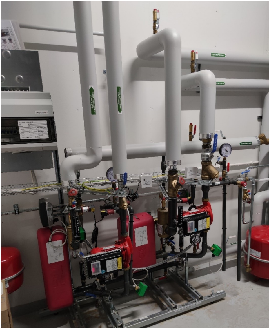
Kuva 11. Lämmityksen alajakokeskus IV-konehuoneessa.
