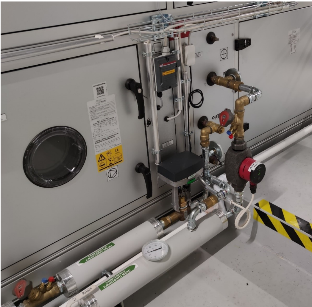
Kuva 19. Ilmanvaihtokoneen jälkilämmityspatterin sekoitusryhmä.
