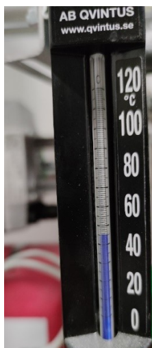
Kuva 22. Putkistoon asennettu nestepatsaslämpömittari.
