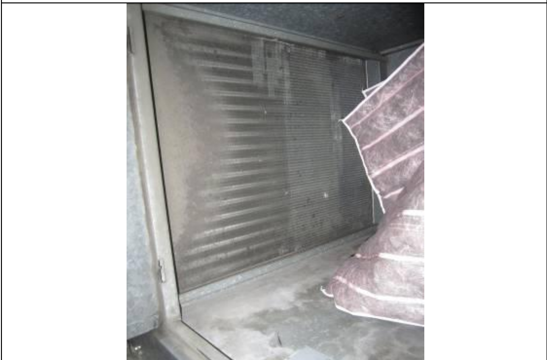
Kuva 4. 203 TK:n LTO-kenno on huomattavan likainen.
