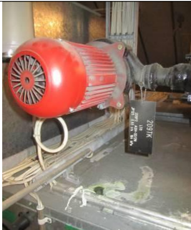
Kuva 8. 209 TK:n LTO-piirin pumppu vuotaa.
