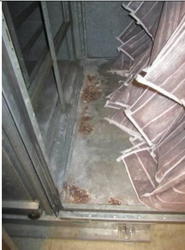
Kuva 9. 210 TK:n tuloilmakammion kosteusvaurioita.
