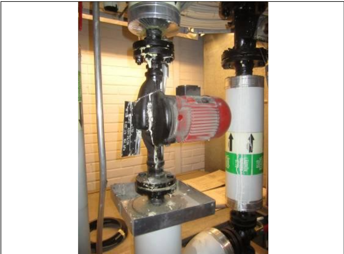
Kuva 3. 203 TK:n LTO-piirin kiertopumpun laipat vuotavat.
