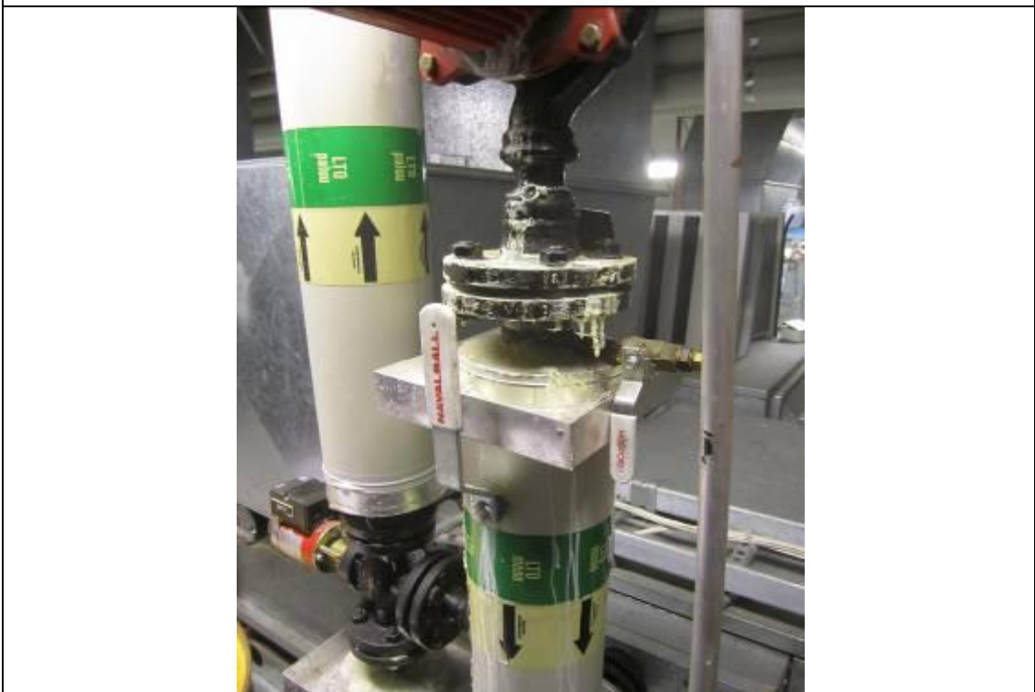
Kuva 6. 208 TK:n LTO-piirin pumppu vuotaa.
