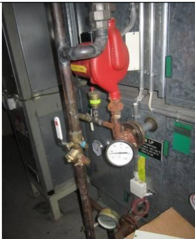
Kuva 14. 218 TK:n lämmitysverkoston putkissa on runsaasti ruostetta.
