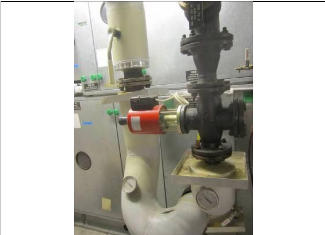
Kuva 5. 206 TK:n jäähdytysverkon laipoissa on ruostetta.
