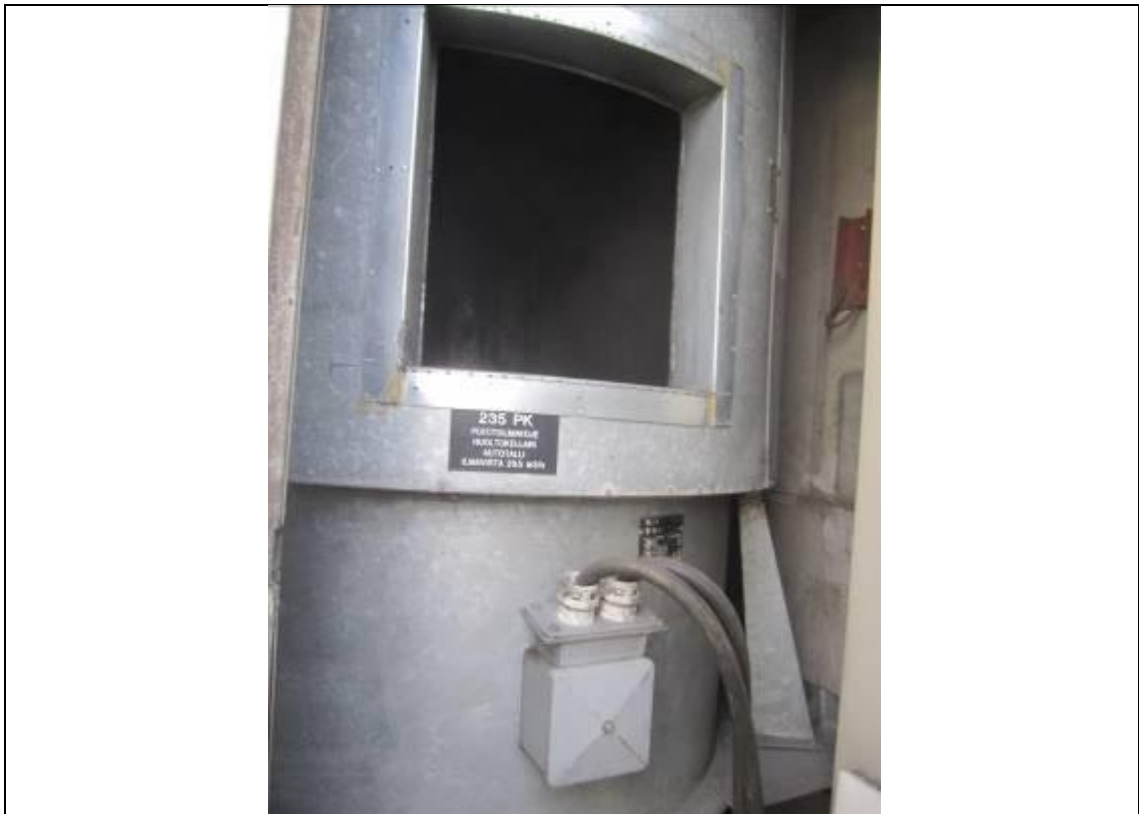
Kuva 15. 235 PK:n kyljen huoltoaukon luukku puuttuu.
