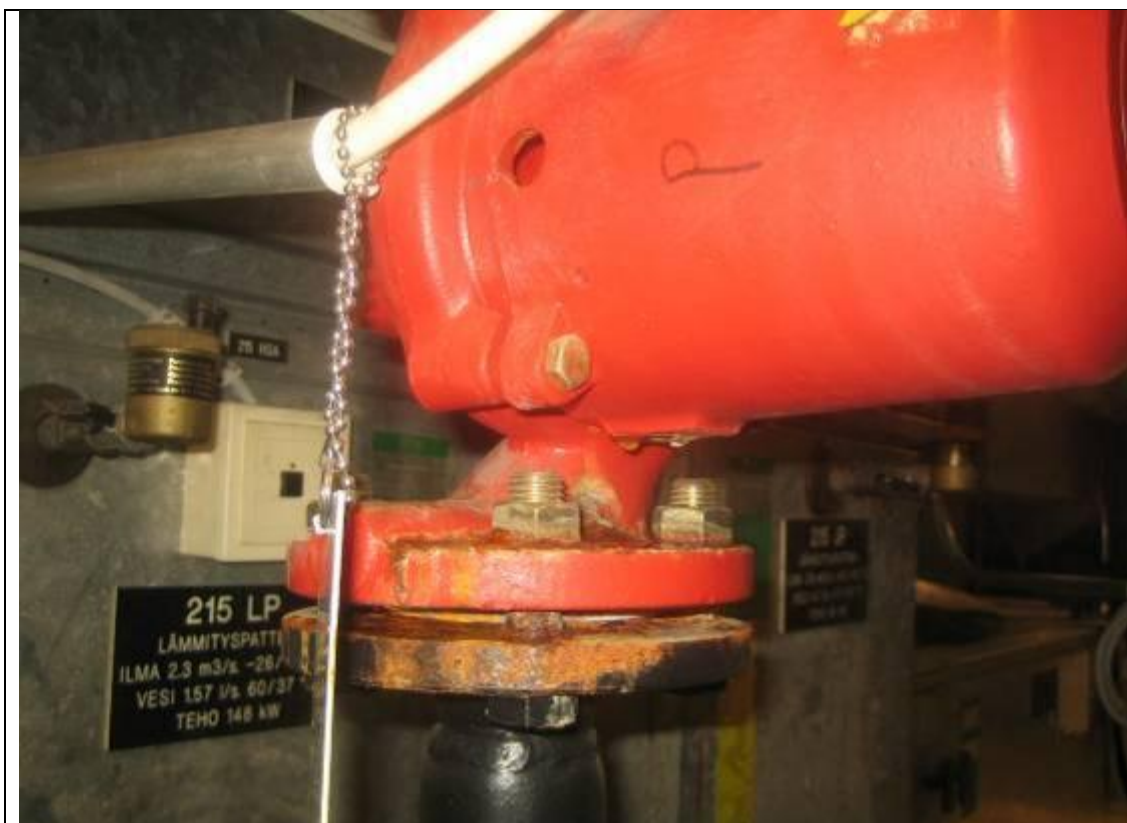
Kuva 11. 215 TK:n lämmityspatterin vuotava kiertopumppu.
