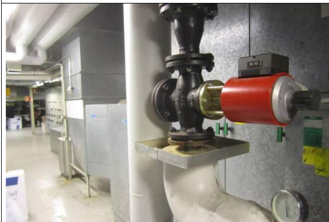
Kuva 12. 216 TK:n jäähdytysverkoston moottoriventtiilin laipoissa on pintaruostetta.
