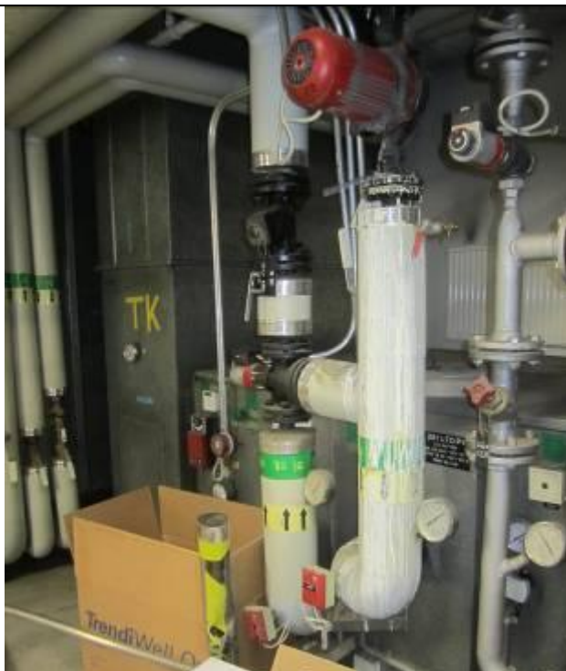
Kuva 2. 201 TK:n LTO-piirin laipat vuotavat.
