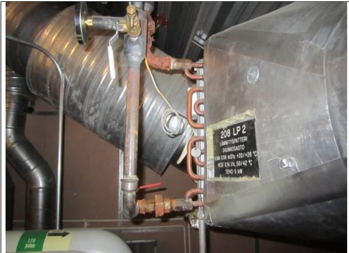
Kuva 7. 208 TK:n jälkilämmityspatteri 2:n sekoituspiirissä on korroosiota.
