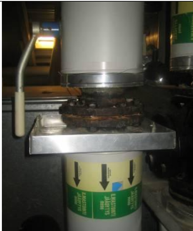
Kuva 10. 212 TK:n jäähdytysputkiston laippojen korroosiovaurioita.
