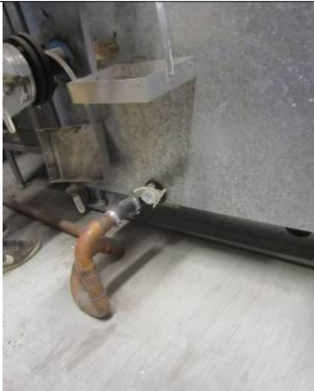
Kuva 1. 201 PK:n LTO-patterin kondenssiviemäröinti on tulpattu ja irrotettu kammiosta.
