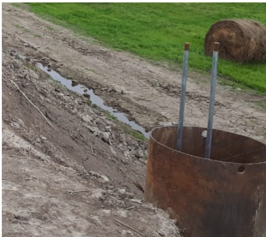
Kuva 27. Huokosvedenpainemittarin suojaus teräspukella.
