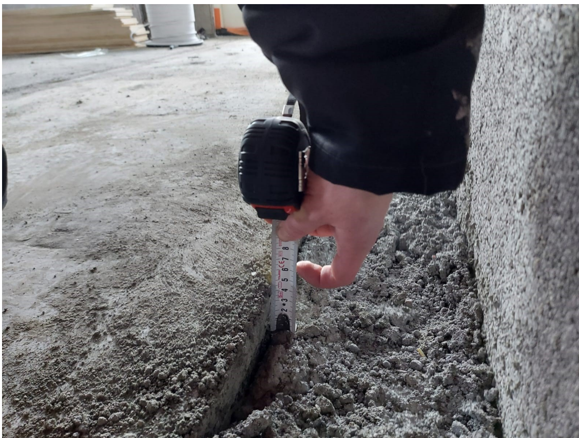
Kuva 16. Vajaaksi jäänyt kylpyhuonevarauksen valu
