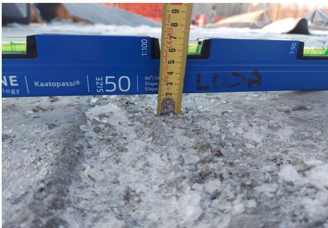
Kuva 13. Ontelon reunassa oleva vajeus paksuudessa
