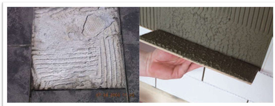
Kuva 15. Esimerkki laastipeitosta. Vasemmalla uimahalliin riittämätön laastipeitto, jossa näkyy laastikamman jälki ja oikealla tavoiteltu 100 % kiinnitys. (Laattapiste Oy 2020)
