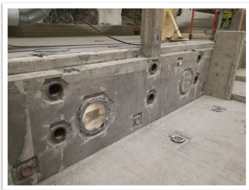
Kuva 17. Esimerkki läpivientien määrästä yhdellä seinän osuudella. Pienellä, noin viiden metrin, matkalla voidaan laskea jo 12 läpivientiä altaan pystypinnalla.
