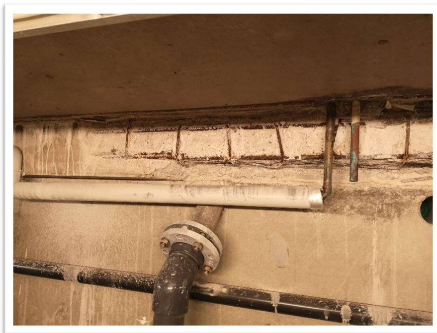
Kuva 19. Raudoitteet ovat ruostuneet ja rapauttaneet altaan betonia vuotokohdassa. Raudoitteet on puhdistettava ja suojattava ennen betonin korjausta.
