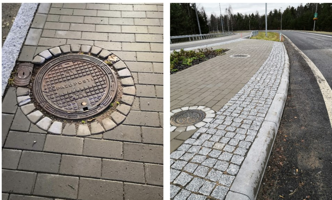
KUVA 6. Kaivojen kannet, joista vasen edustaa huonoa ja oikea hyvää rakentamista
