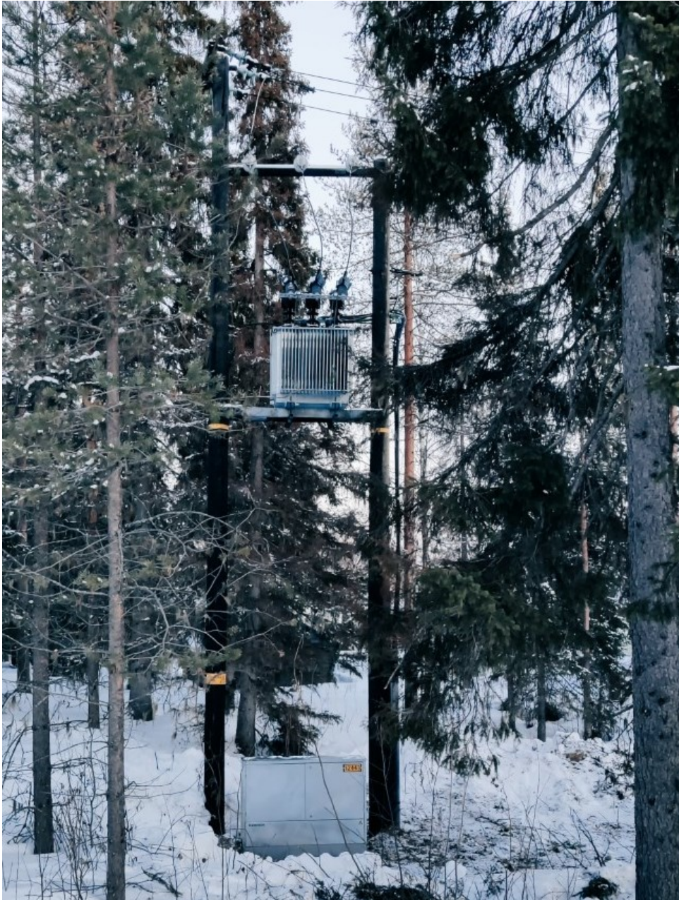
KUVA 9. Pylväsmuuntamo ja maakaapelointi asiakkaille asti
