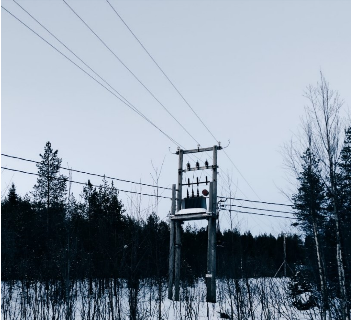
KUVA 8. Pylväsmuuntamo ja asiakkaalle lähtevä AMKA-linjat
