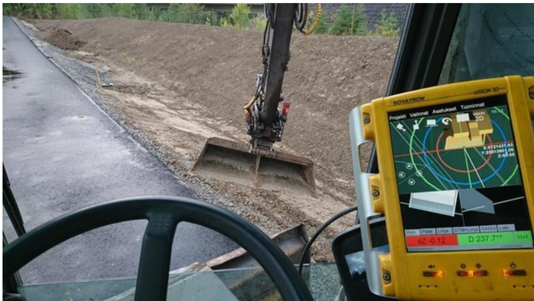
Kuva 12. Novatron-valmistajan koneohjausjärjestelmän näyttö, josta nähdään kauhan sijainti ja haluttu kaivu taso[24.]
