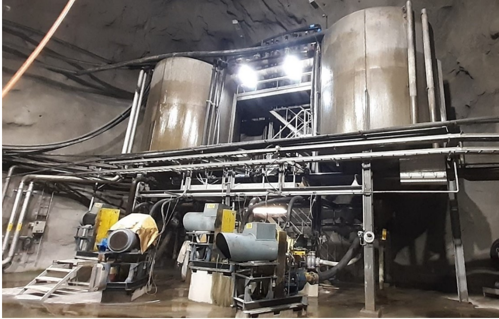
Maanalaisen kaivoksen 500m tason pumppaamo
