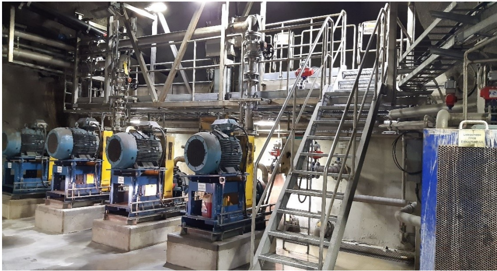
Maanalaisen kaivoksen 640m tason pumppaamo
