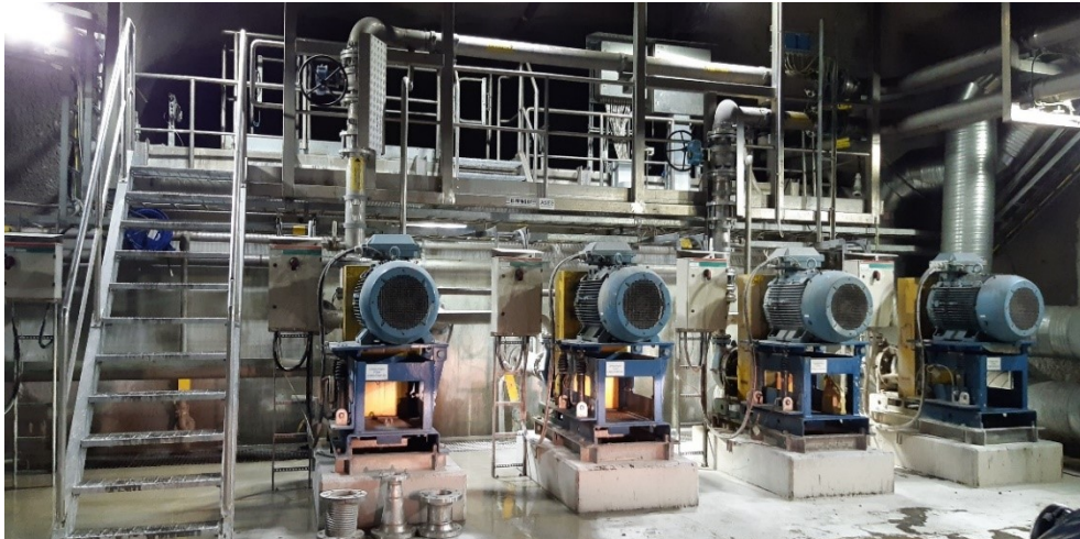
Maanalaisen kaivoksen 8250m tason pumppaamo
