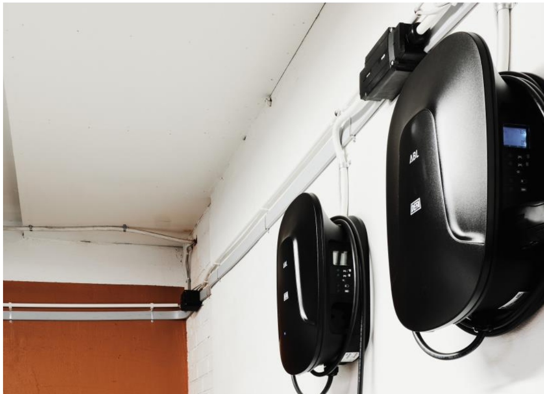
Kuva 7. Sähköautojen latauspisteet lattakaapelijärjestelmällä toteutettuna. Seinällä olevasta lattakaapelista haaroitusrasian avulla sähkö syötetään sähköautojen latauspisteille. (27, s. 2.)
