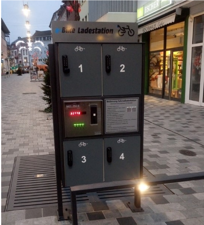
Kuva 15. Julkinen latauskaappi sähköpyörien akuille (25).
