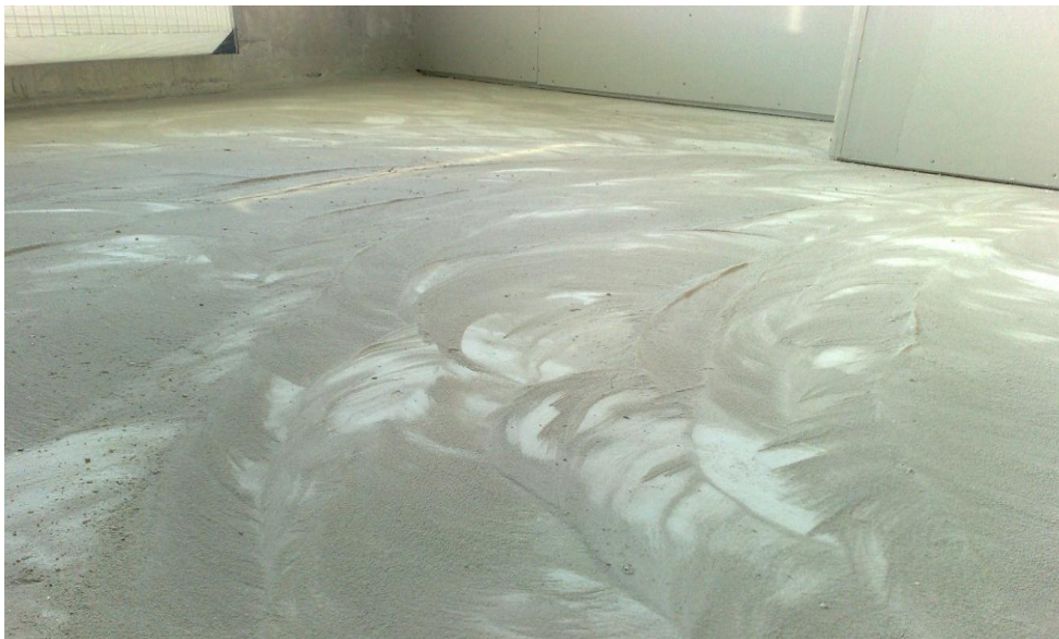
Kuva 1 Lattia sementtiliiman poiston jäljiltä
