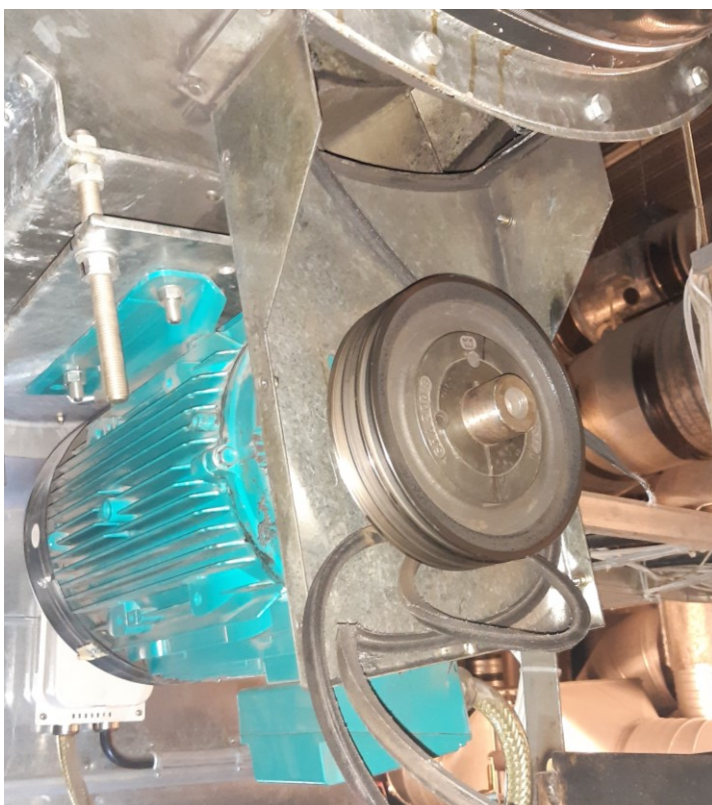
Kuva 9. Kanavapuhaltimen katkenneet kiilahihnat
