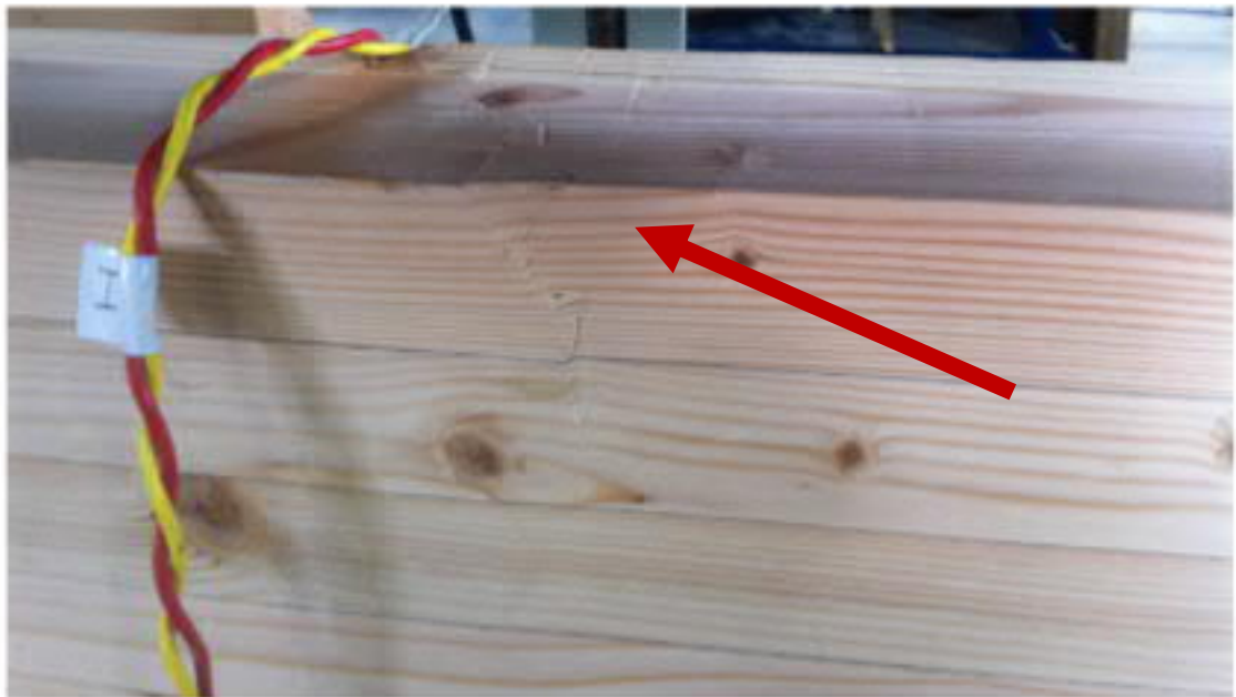
Kuva 8. Liimapuupalkin puristusvaurio yläpinnassa (leimapaine) (www.researchgate.net)
