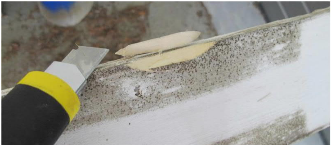
Kuva 5. Pintavaurio puussa (Puujulkisivujen huolto- ja korjausmaalaukset, www.tikkurila.fi )
