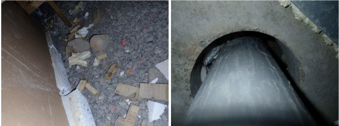
Kuva 10. Alapohjaan jätettyä rakennusjätettä ja tiivistämättömiä läpivientejä laajennusosan rakennustyön jäljiltä. Kuva: Sisäilmasto ja kosteustekninen kuntotutkimus Länsimäen koulu 2019
