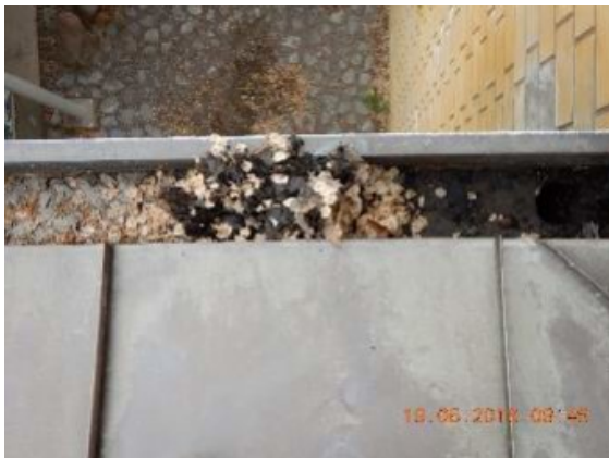
Kuva 5. Räystääkourut ovat osittain tukossa orgaanisesta aineksesta. Kuva: Leppäkorpi raportti 11.10.2018
