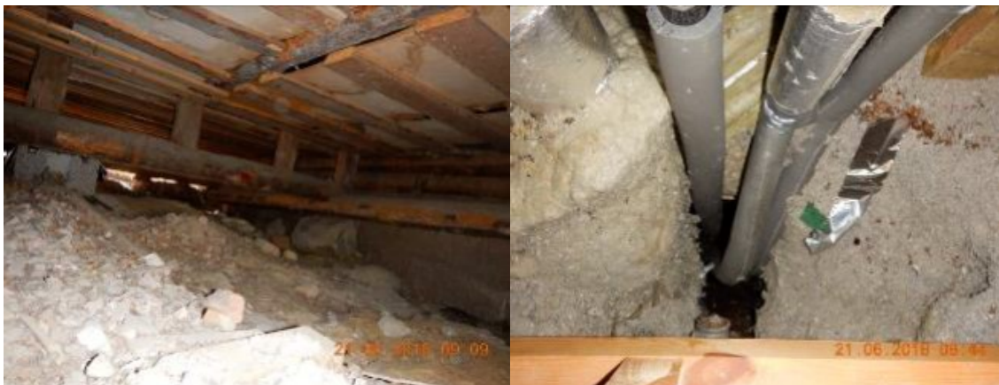
Kuva 6. Alapohjan alla, ryömintätilassa rakennusjätettä ja läpiviennit eivät ole tiiviit. Kuva: Leppäkorpi raportti 11.10.2018
