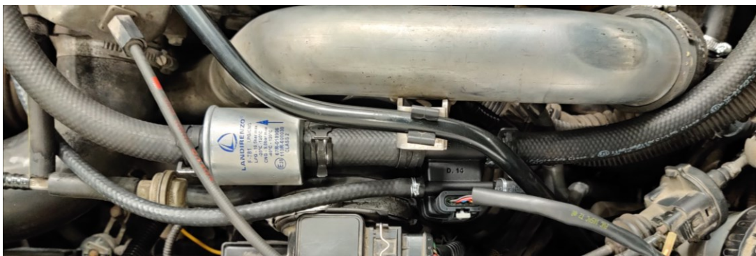
Kuva 17. Kaasusuodatin ja paineanturi matalapainekaasuputkessa ennen injektoreita.
