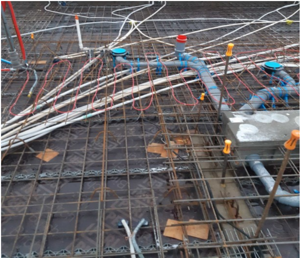
KUVA1. Talotekniikkaa paikallavaaluholvissa (Kareinen, 2020)
