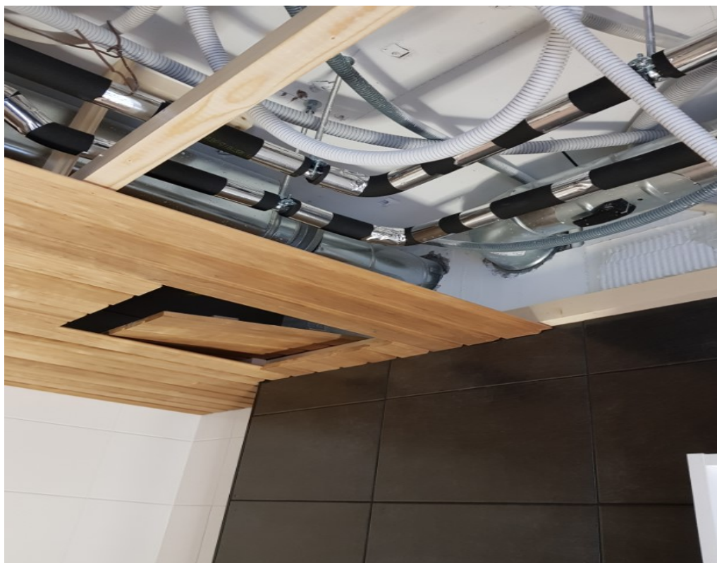
KUVA 8. Kylmävesiputket eristettynä alakaton sisällä
