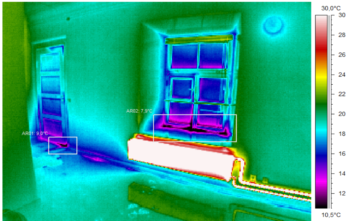
Kuva 11. Rakennus C 49 As B. Ikkunan ja oven lämpövuoto.
