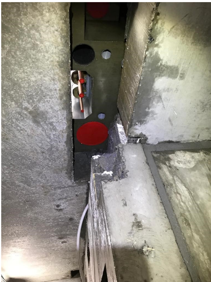
Kuva 5. Seinäelementistä puuttuu varaus ilmanvaihtoputkelle. IV-putkelle jätetty tila liian ahdas.
