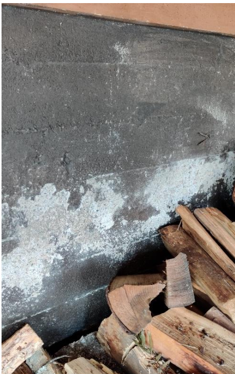
Kuva 1. Kuluneen betonilaatan pinta.
