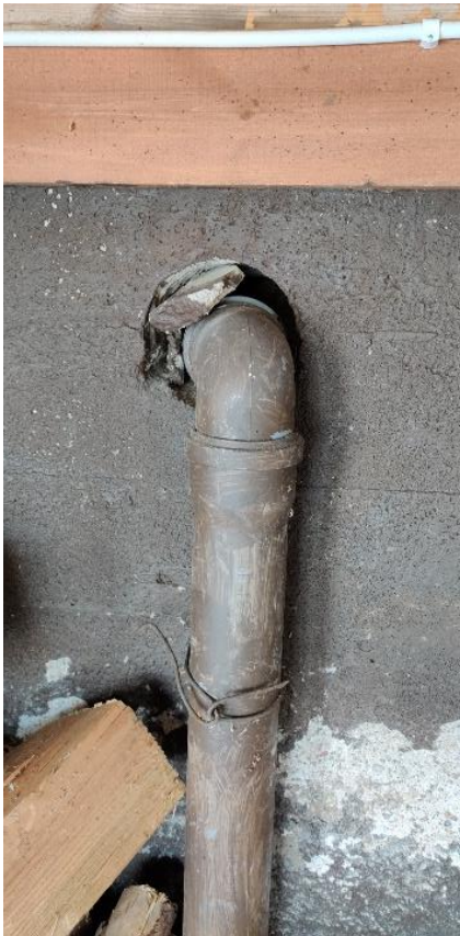
Kuva 3. Läpivienti on puutteellinen.
