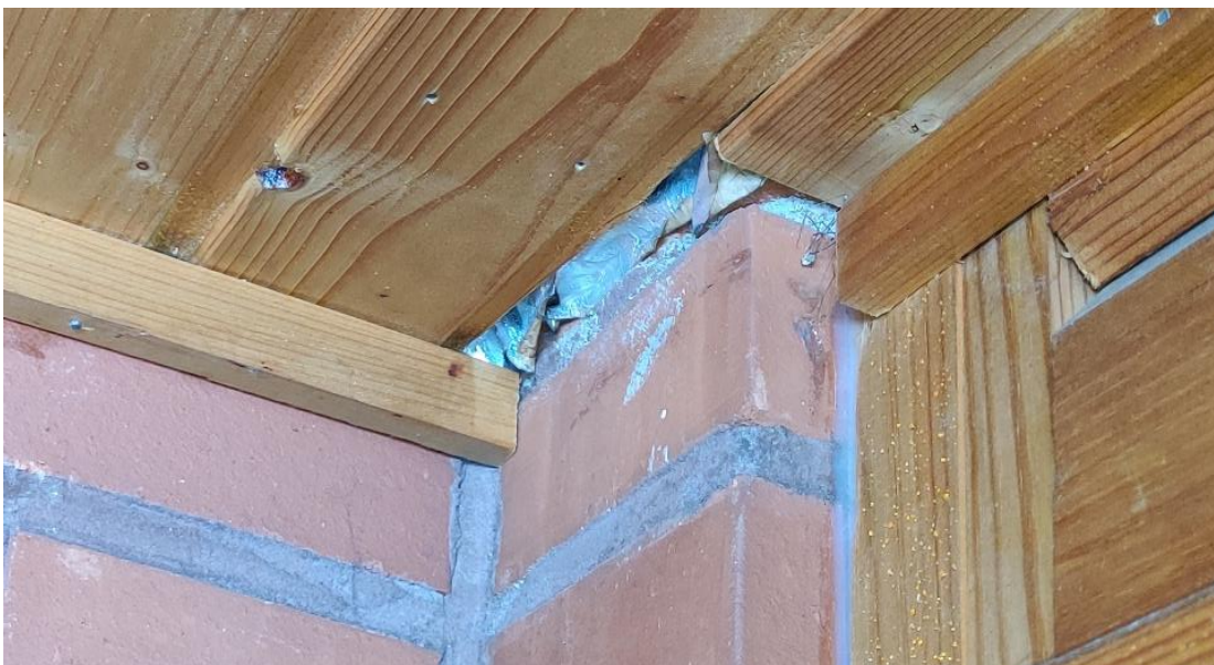
Kuva 36. Saunan nurkasta puuttuu paneloinnin lista.
