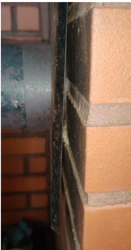
Kuva 34. Hormin suojaletti rakoilee.
