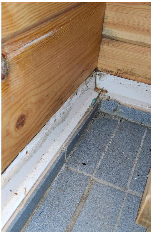
Kuva 32. Pesuhuoneen nurkan eristys on huonoin.
