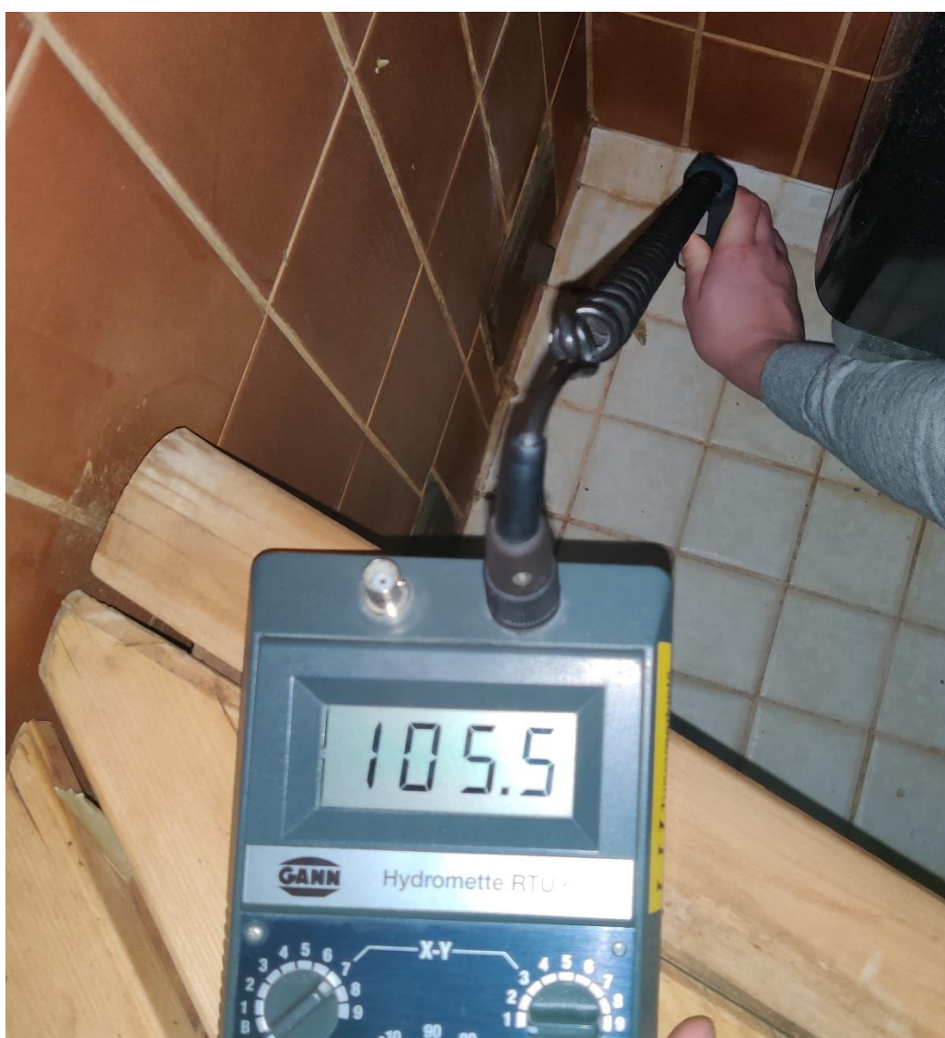
Saunan kiukaan alla lattialaattojen pintakosteuksissa pientä poikkeamaa
