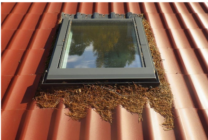
Kuva 21. Kattoikkunan ympärille kerääntyy herkästi roskaa ja jäätä [20.]
