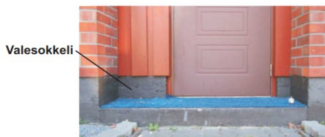
Kuva 8. Valesokkelin tunnistaminen. Ulko-oven alareuna lähes maanpinnan tasalla sekä sokkelin yläreunan alapuolella. [16.]
