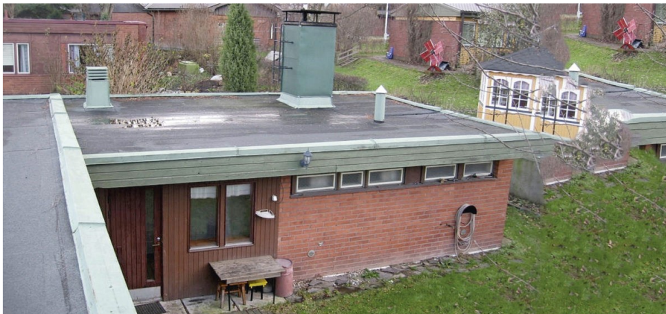
Kuva 22. Vesi lammikoituu tasakatolle [21.]
