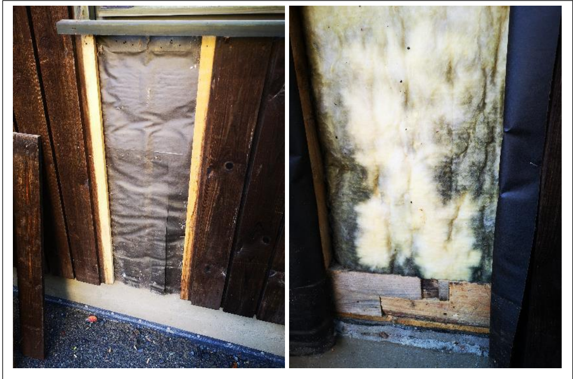
Kuva 3 & 4. Kuvan ulkoseinärakenteessa ei ole tuuletusrakoa. Vasemmalla kuvassa 3 näkyy tervapaperissa rypistyminen kosteuden takia. Oikealla kuvassa 4 ilmapirrat ovat kuljettaneet epäpuhtauksia eristeeseen, joka on edesauttanut eristeen turmeltumista. (Minkkinen 2020)
