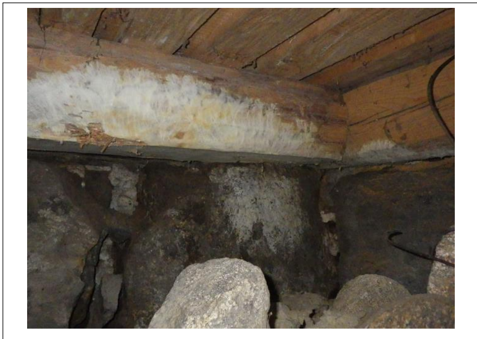
Kuva 5. Kuvassa on puurakenteen lahottajasisienirihmastoja, heikosti tuulettuvassa alapohjassa. (Minkkinen 2019)
