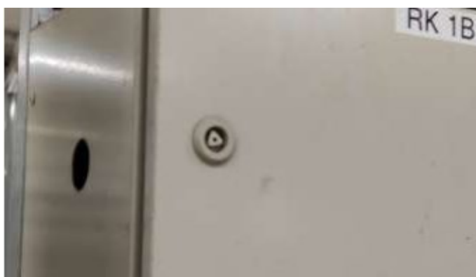
Kuvio 19. Vanhan käytöstä poistetun kaapelin läpivienti
