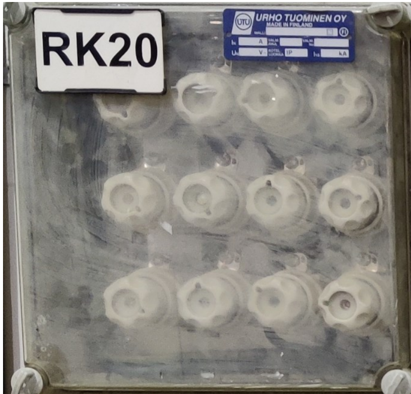
Kuvio 12. RK20 puuttuva sormisuojalety
