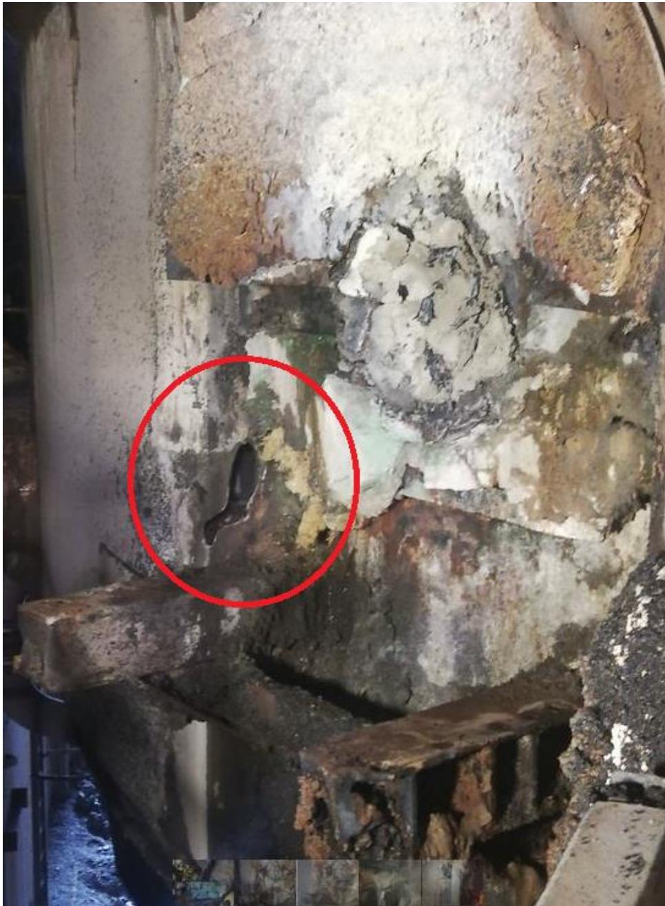
Kuva 4. Vedenkeruukotelon vaurio (Outokumpu Chrome Oy 2021.)
