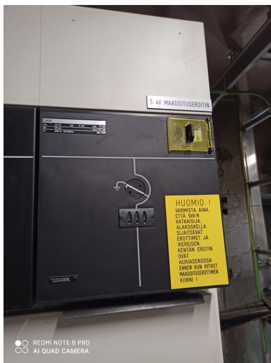
KUVA 4. Käytöstä poistettu vanhempi keskijännitekojeisto
