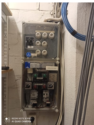
KUVA 9. Jätevesikaivon pumppujen ohjauskeskus
