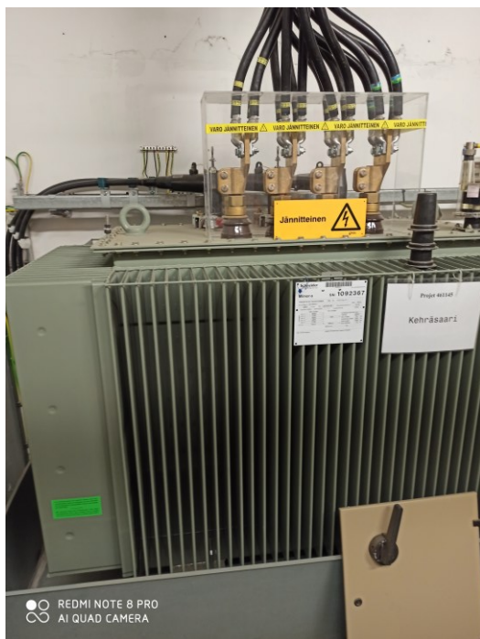
KUVA 5. B-talon hermeettisesti suljettu öljymuuntaja
