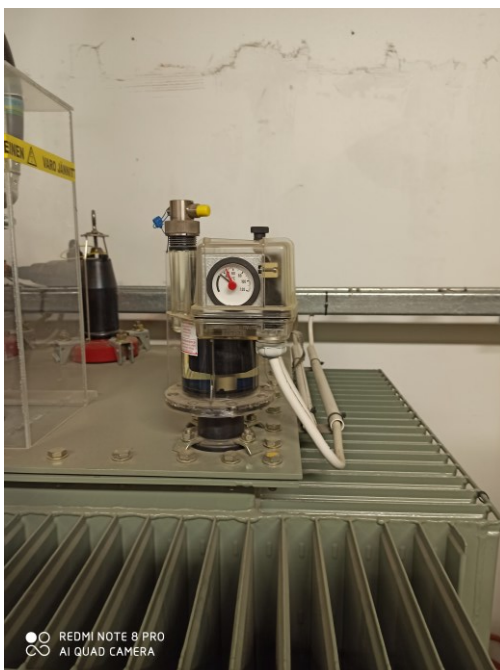
KUVA 6. Jakelumuuntajassa oleva suojarele
