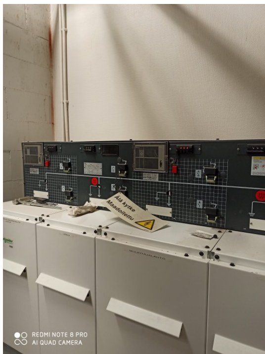
KUVA 3. Käytössä oleva uudempi keskijännitekojeisto
