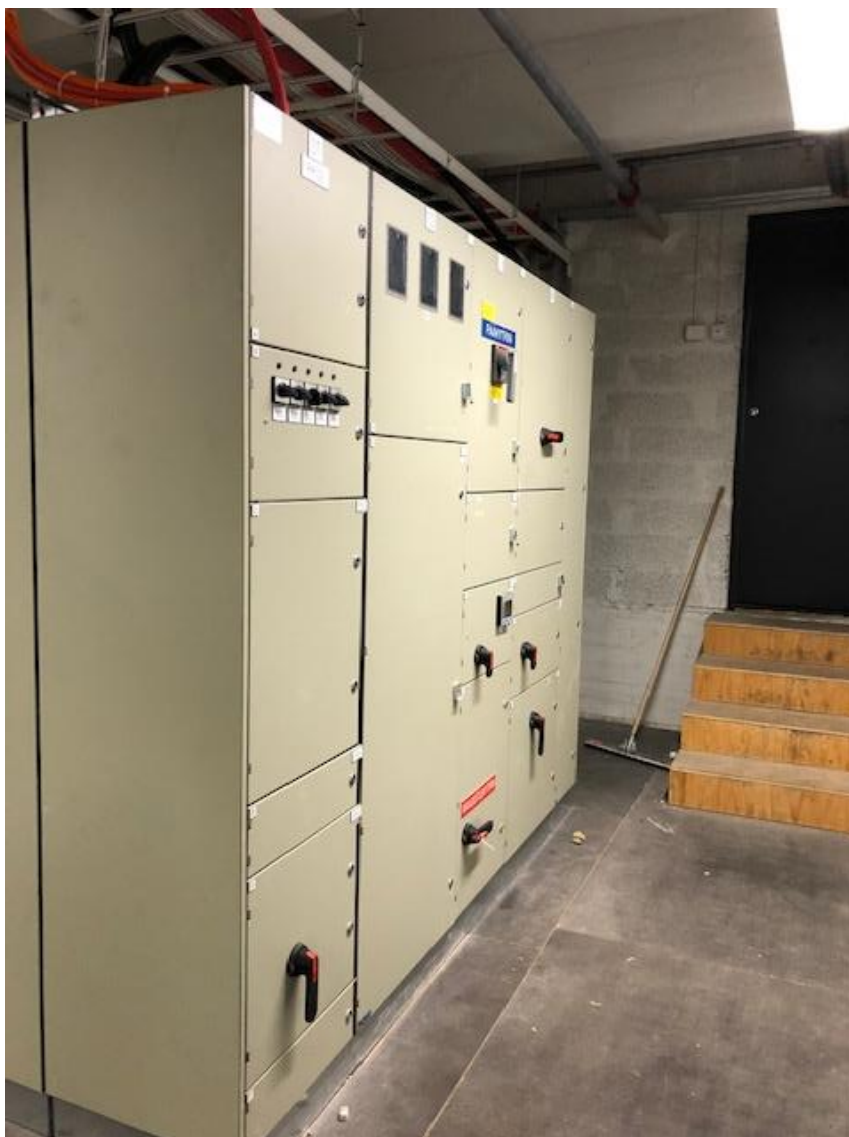
KUVA 5. Sähkötilan riittävä ohitusleveys evakuointi tilanteessa
