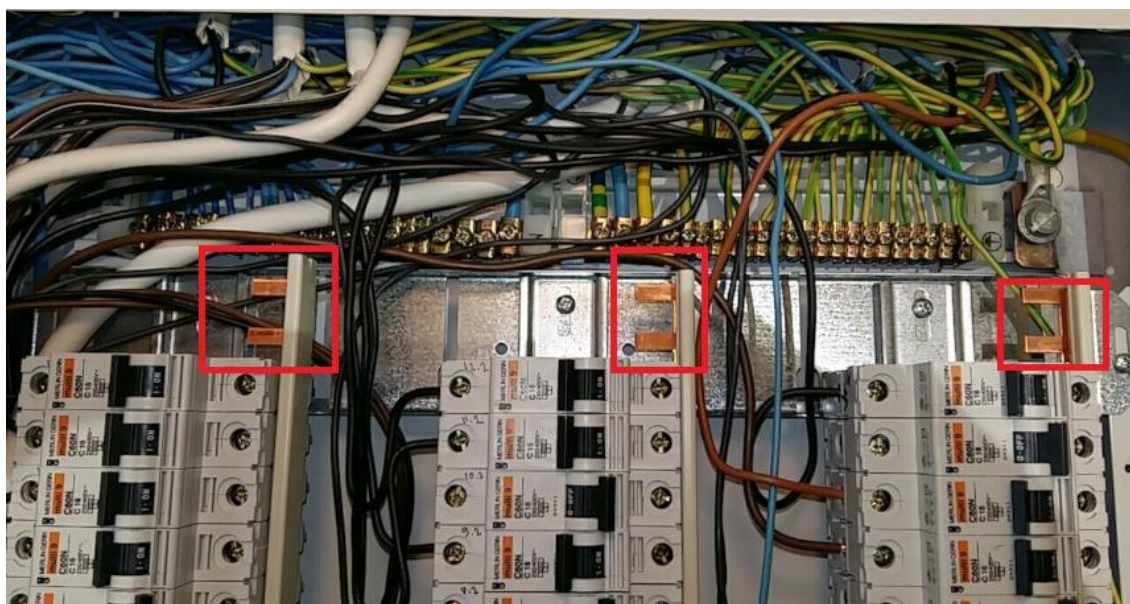
KUVA 8. Puutteellinen kosketussuojaus pääkeskuksessa (Sähköasennus Kimmo Karvonen)
