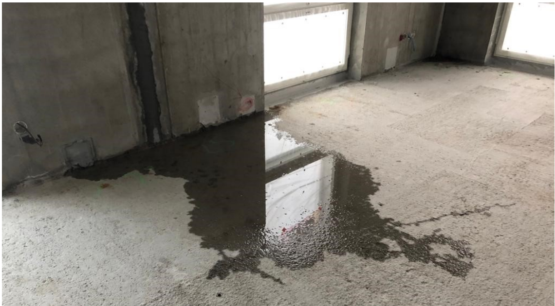
Kuva 4. Kastunut betonilaatta Kuva: Veera Ahlroos
