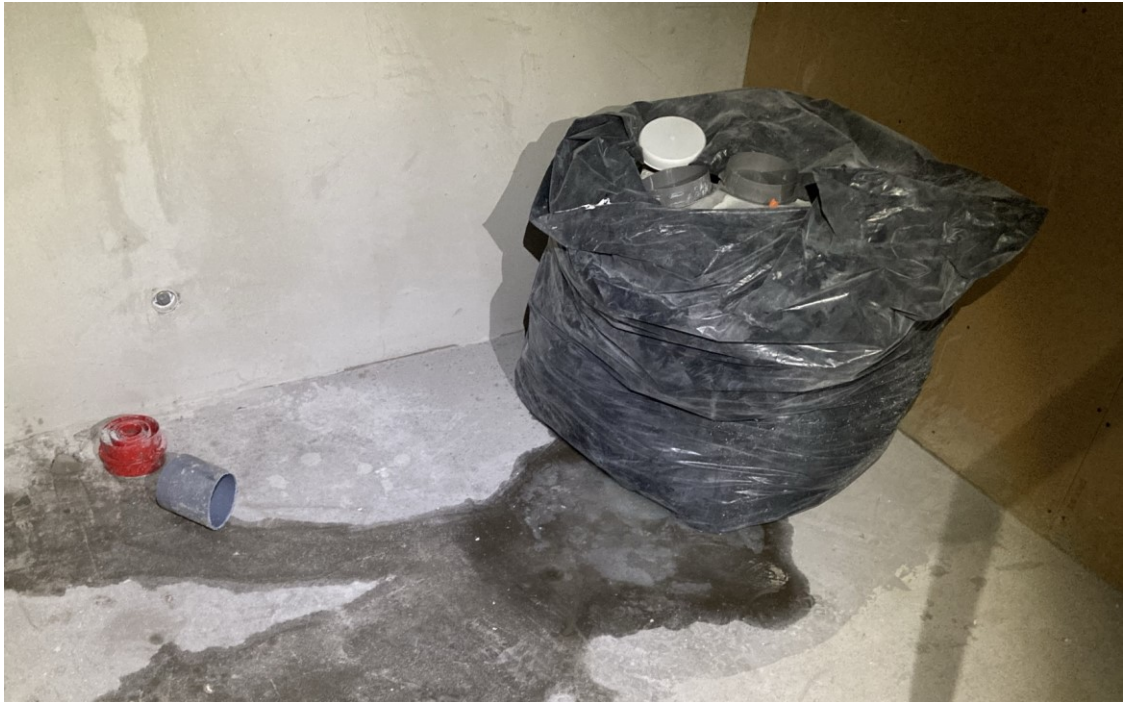
Kuva 9. Roskasäkki on estänyt betonin vapaan kuivumisen Kuva: Veera Ahlroos
