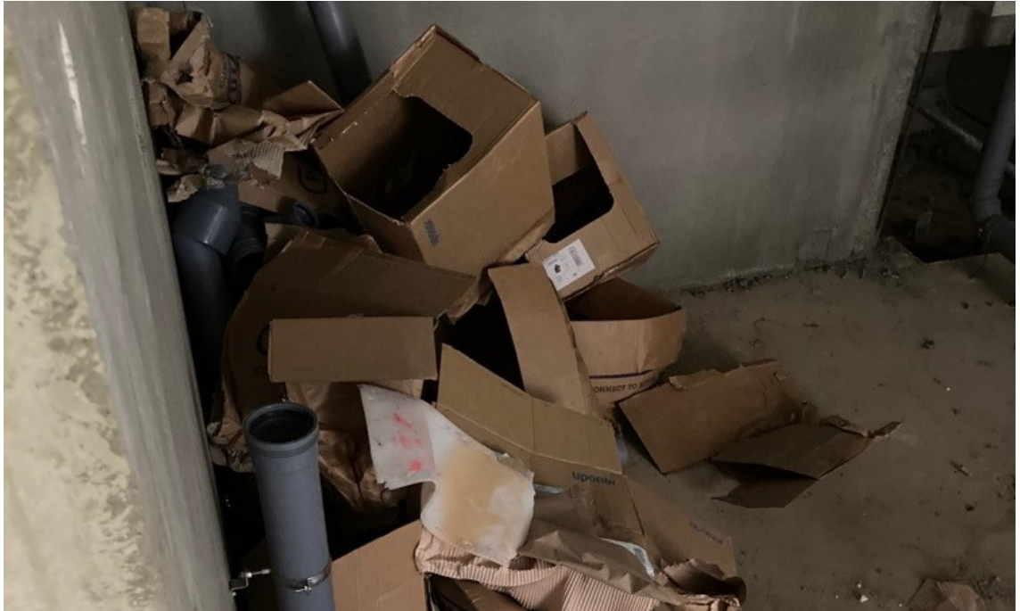
Kuva 6. Roskat keräävät kosteutta ja hidastavat rakenteen vapaata kuivumista. Kuva: Veera Ahlroos
