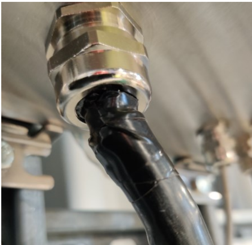
Kuva 2. Vääränkokoinen läpivienti kaapelille.
