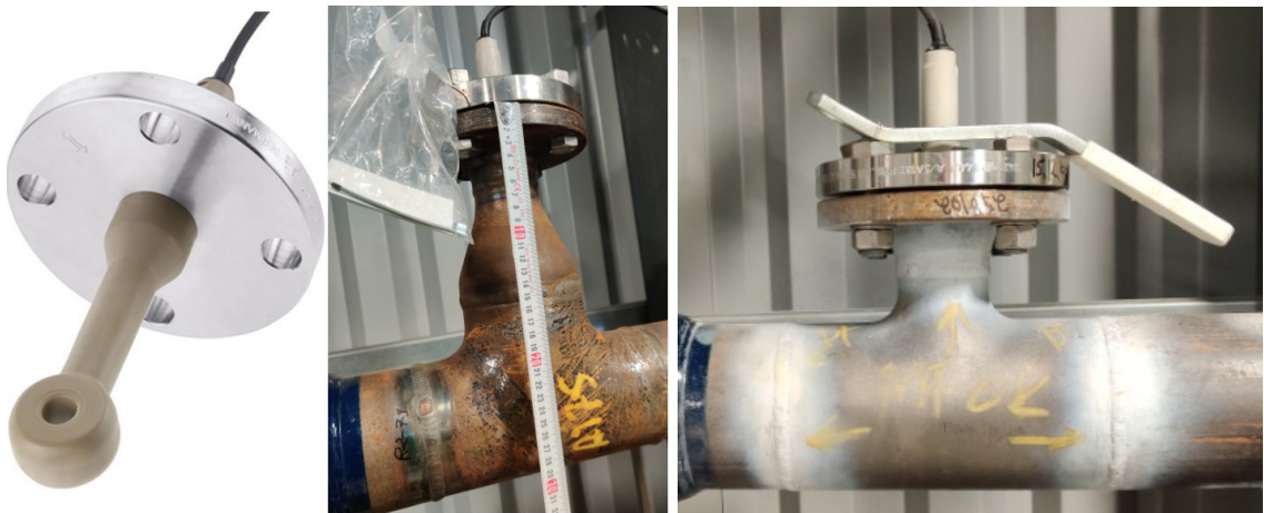
Kuva 10. Vasemmassa kuvassa johtokyky mittauksen yhteen kaula on liian korkea. Oikeanpuoleisessa kuvassa virhe on korjattu.
