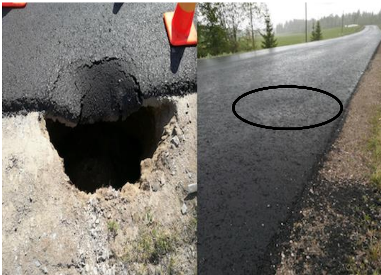
Kuva 16. Alemmat kerrokset ovat pettäneet (kaksi eri tienkohtaa).
