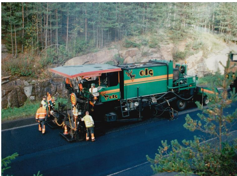
Kuva 5. Remix-työ käynnissä Vt 12 Lammi vuonna 2004. (Jaakko Eurén)
