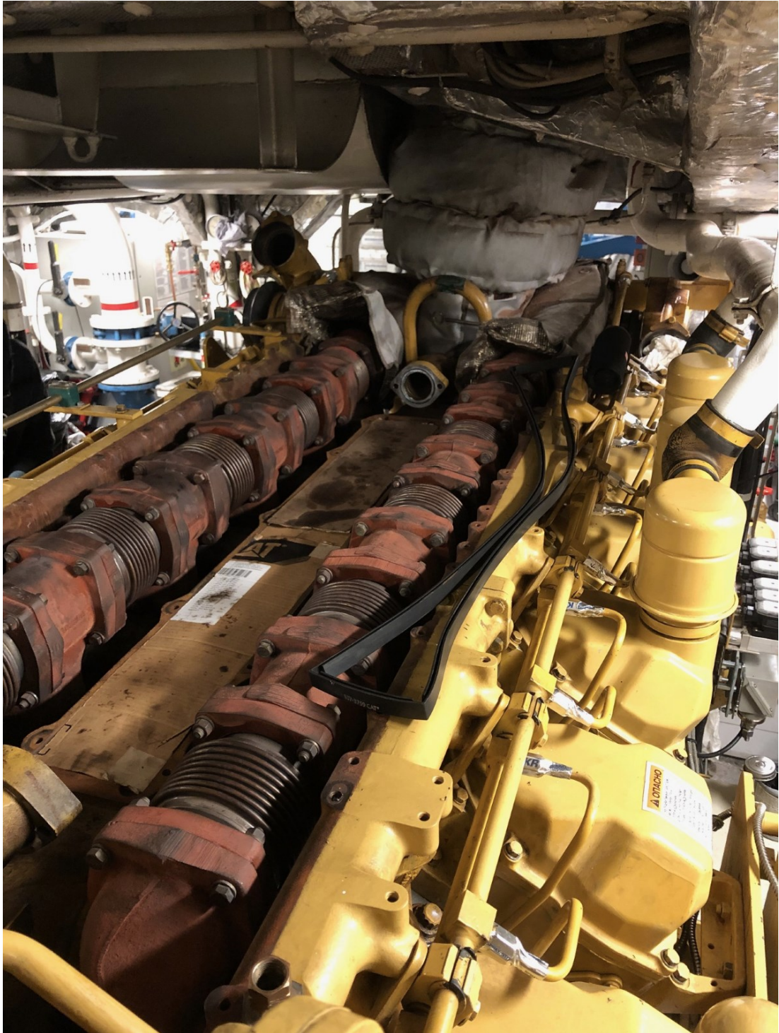
Kuva 24. Linjastoja ja komponentteja asennettuna. (Jari Perä 2020)
