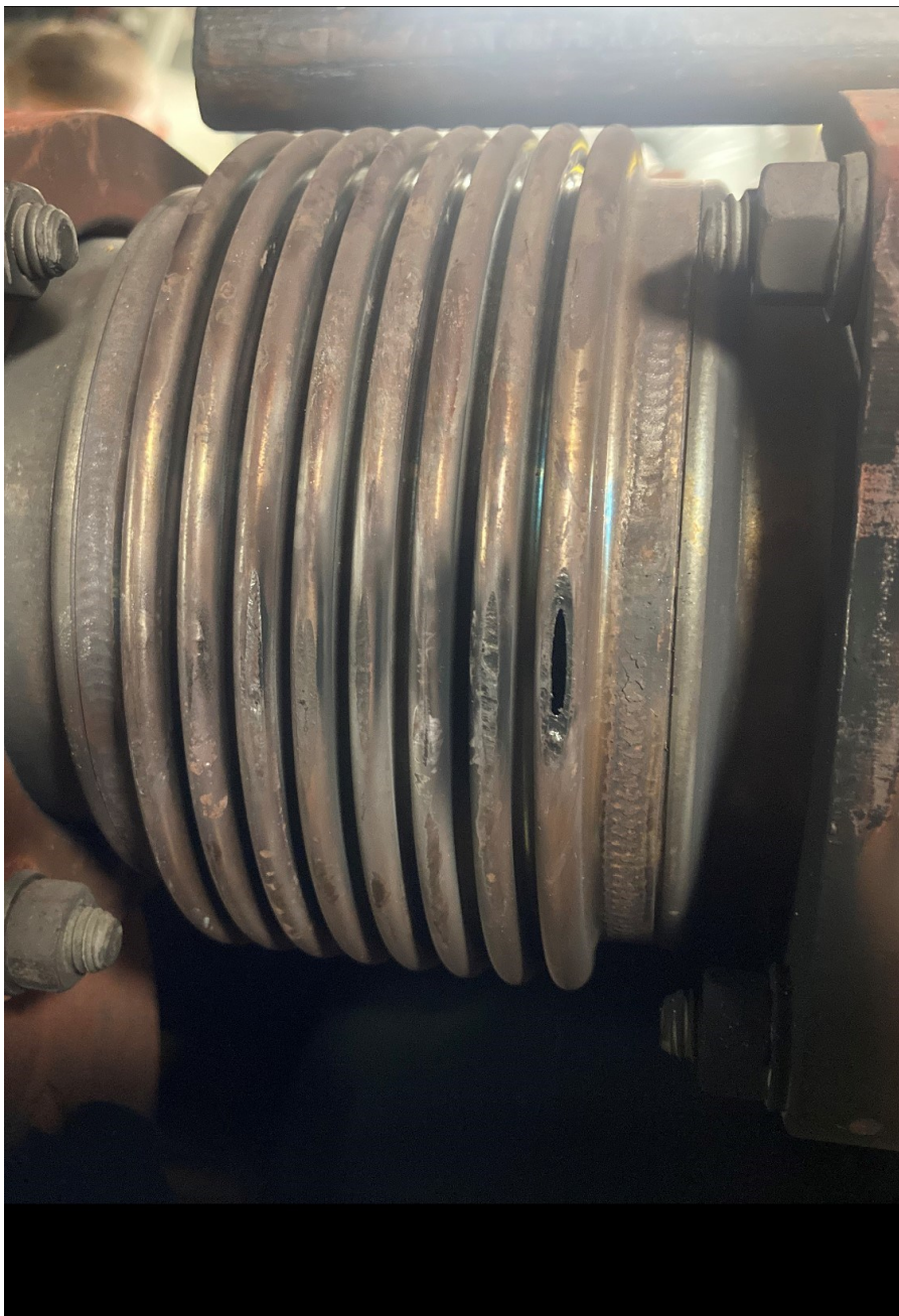
Kuva 11. Vaurioitunut pakosarjan palje. (Ole Desler 2020)
