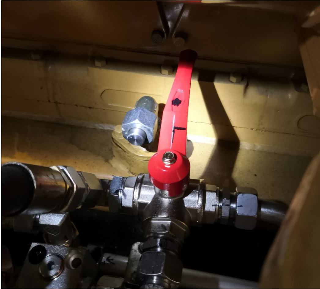
Kuva 7. Esivoitelupumpun venttiili tyhjennysasennossa. (Mikael Peltonen 2020)
