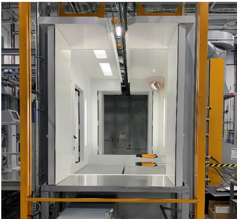
Kuva 16. Jauhemaalauslaitteisto sekä takana suoratoiminen kaasu-uuni. Laitteiston keskellä näkyy traverssi sekä siihen kiinnitetyt neljä automaattijauhepistoolia.
