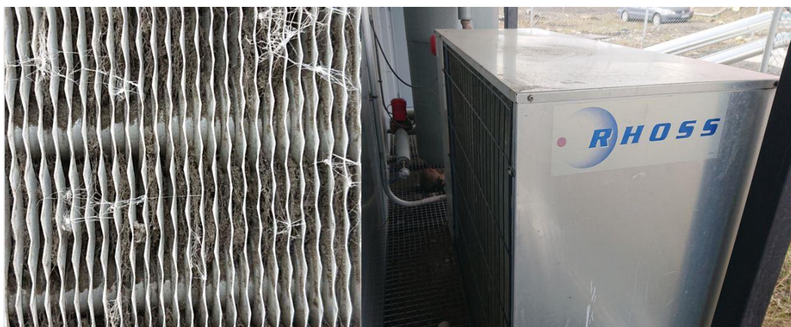
Kuva 7. Jäähdytyslaitteiston kenno oli täysin tukossa
