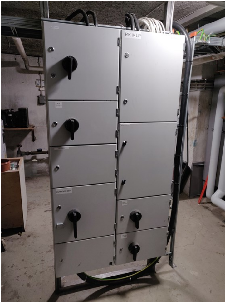
KUVA 9. Lämpöpumppulaitteistoa syöttävä ryhmäkeskus.
