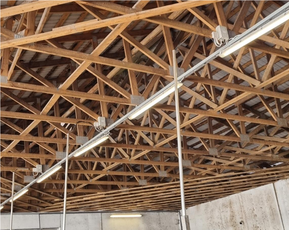
KUVA 4. Laajennusosan valaisimet ruokintapöydän yläpuolella.
