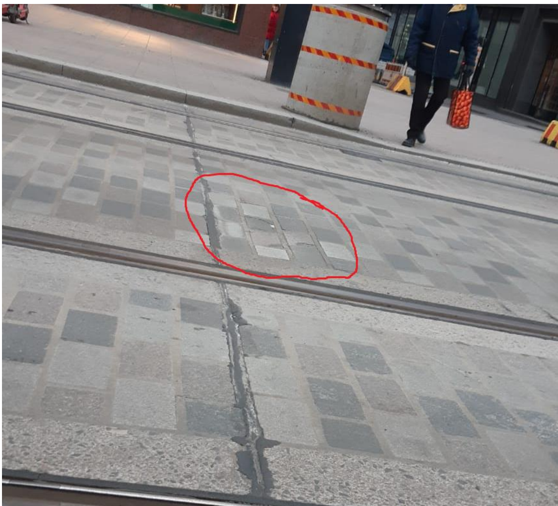
KUVA 3. Rikkoutunutta nupukiveystä Hämeenkadun ja Aleksanterinkadun risteyksessä. (Juuso Aaltonen 2020)
