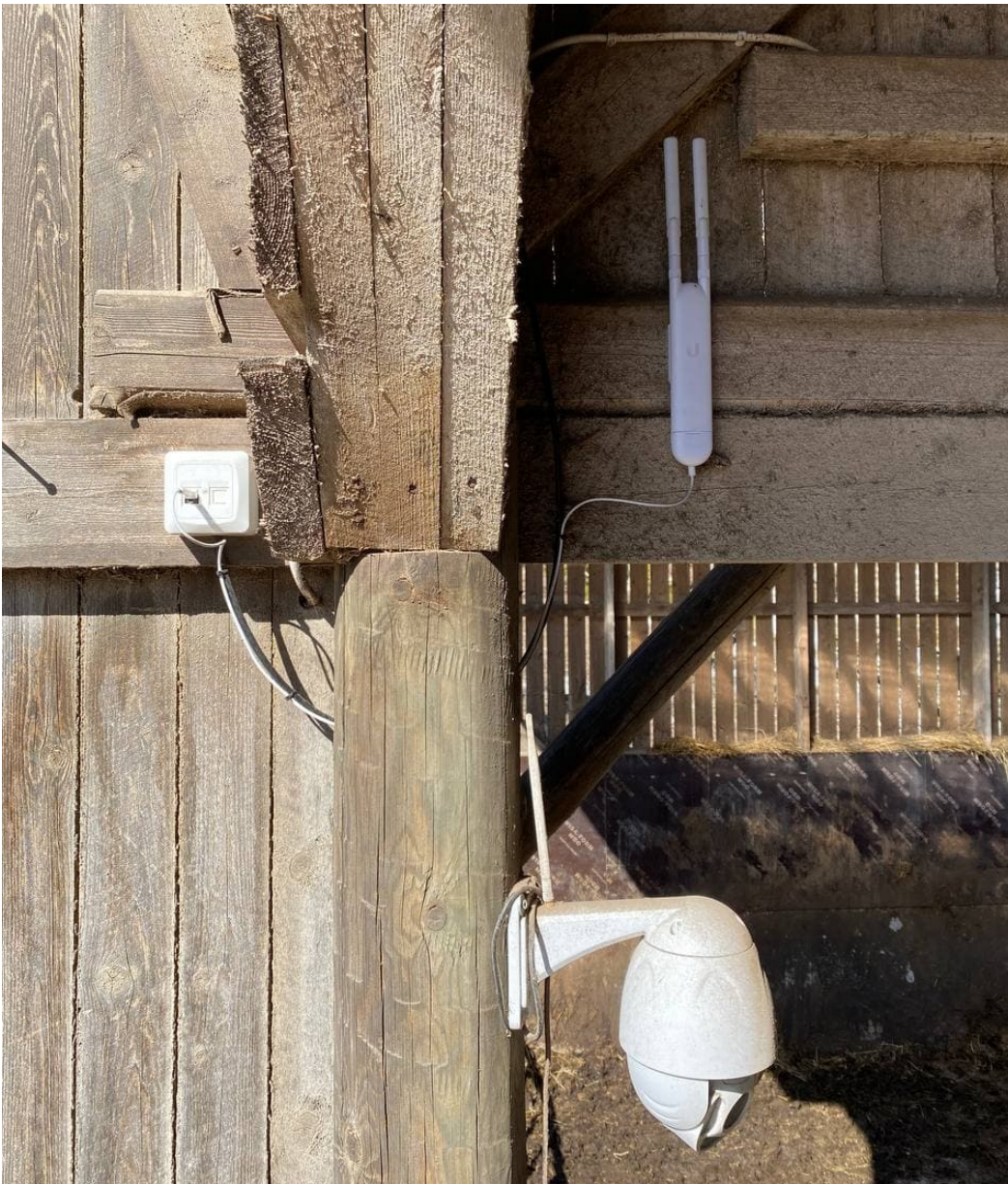
Kuva 4. Vanhan pihatön syöttökaapelit, UniFi tukiasema ja PTZ IP valvontakamera.
