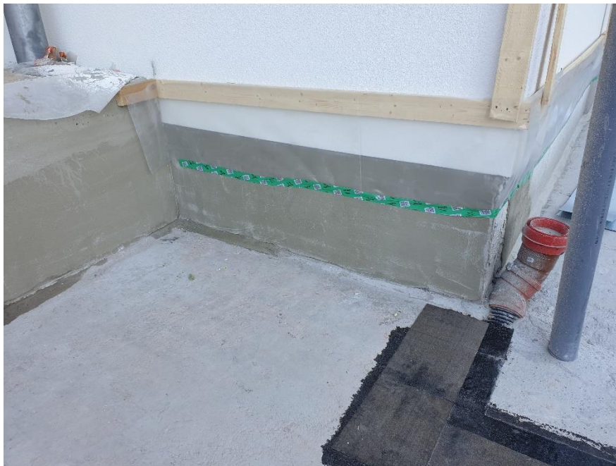
KUVA 13. Suojamuovit asennettiin siten, että valmiiksi rapattuun pintaan ei jää jälkiä suojauksesta. (Kuparinen 2020)
