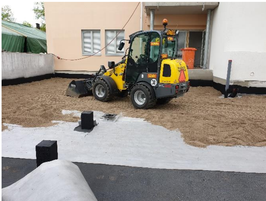
KUVA 16. Ruiskukumin päälle asennettu salaojamatto ja asennushiekka, jonka päällä pystyi jo liikennöimään pyöräalustaisella työkoneella vaurioittamatta ruiskukumia (Kuparinen 2020).
