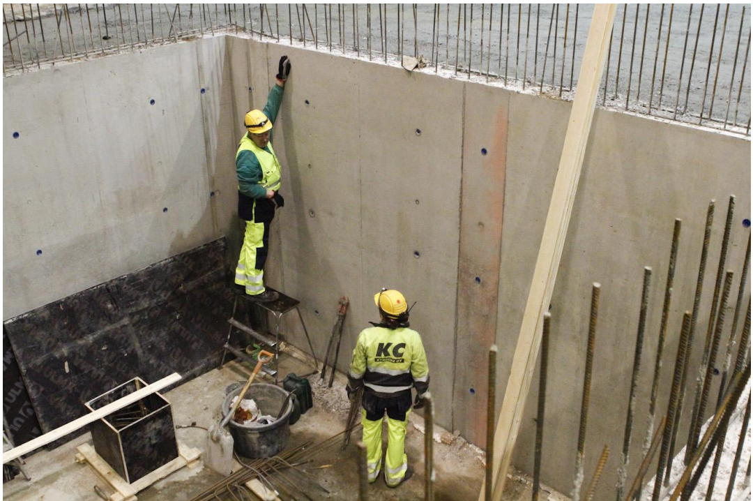
Kuva 15. Alimmat surireiät osoittautuivat vesivuodoille alttiiksi
