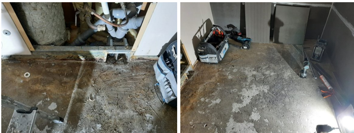
KUVA 7 ja 8. Purettua lattiapintaa vesivahinkoalueelta.
