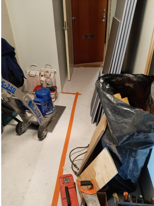
KUVA 12. Työkohteen varastointitilan ahtautta.
